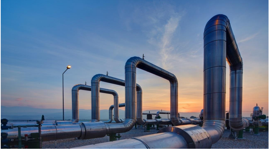
Şekil 3.1 Kızıldere-II JES reenjeksiyon pompa istasyonu
