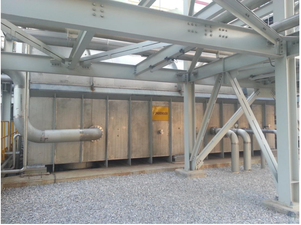
Şekil 6.6 Kızıldere-II JES kondenser ünitesi
