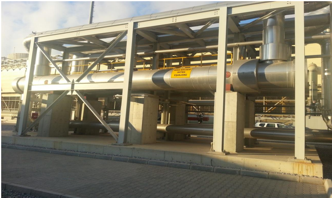
řekil 6.4 Sarayköy ısıtma eřanjörü
