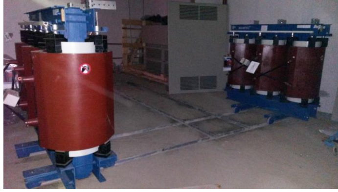
Şekil 6.8. 34,5/0,4kV 1000 kVA Kuru tip iç ihtiyaç trafoları
