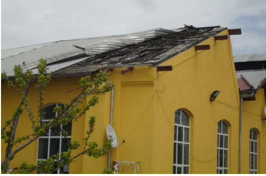
Şekil 5. 164 14 hattın bulunduğu bölümün yan cephesi ve arka cephesi, PVC'den imal edilmiş yeni pencereler, çatı kaplama malzemesindeki kayıplar
