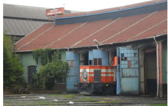
Şekil 5. 67 Lokomotif Giriş Cephesi, 13, 14, 15, nolu hatların kapıları ve çatı aydınlığı, 16, 17, nolu hatların pencereleri
