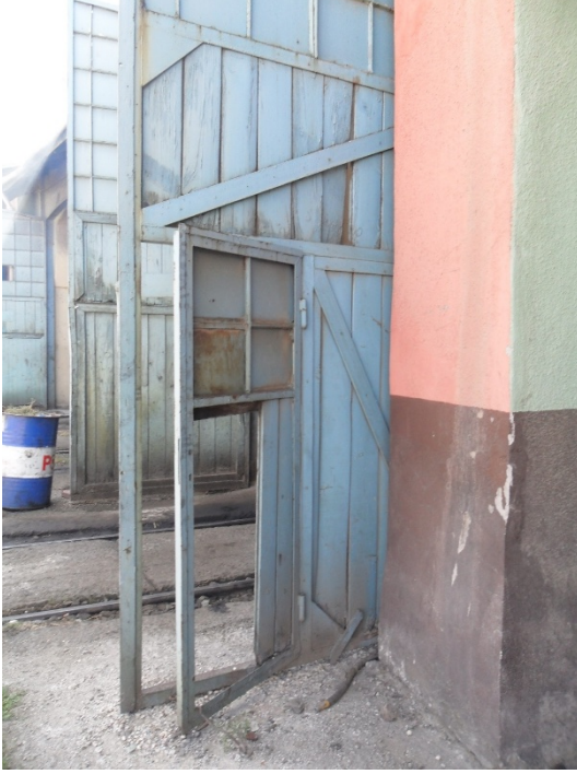
Şekil 5. 74 nolu hattın bulunduğu bölümün lokomotif giriş – çıkış kapısı
