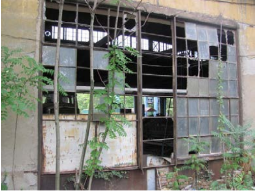
Şekil 5. 25 Arka cephe, duvarlardaki bozulmalar, orjinal pencerelerdeki bozulmalar
