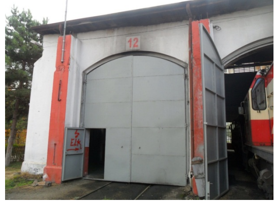
Şekil 5.290 Ön cephe, 12 nolu hattın, lokomotif giriş – çıkış kapılarının dış yüzeydeki taşıyıcı kolonlarla ilişkisi ve üzerindeki küçük kapı
