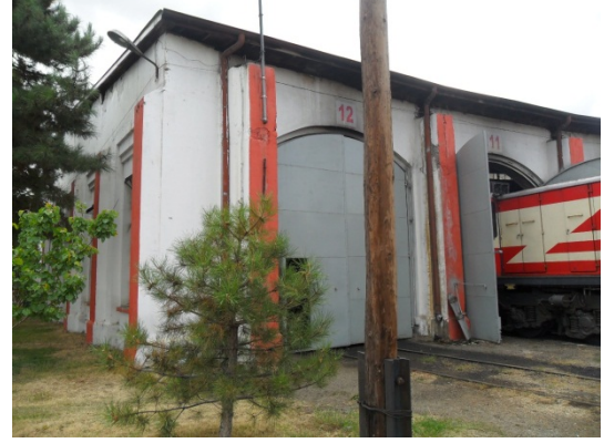
Şekil 5. 278 Ön ve yan cephe, 11, 12 nolu hattın bulunduğu bölüm, lokomotif giriş - çıkış kapıları, taşıyıcı kolonlar
