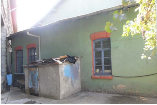
Şekil 5. 86 Lokomotif Giriş Cephesi, tornahane olarak kullanılan bölüm, depoya bitişik olarak inşa edilmiş Tülomsaş atölyesi.
