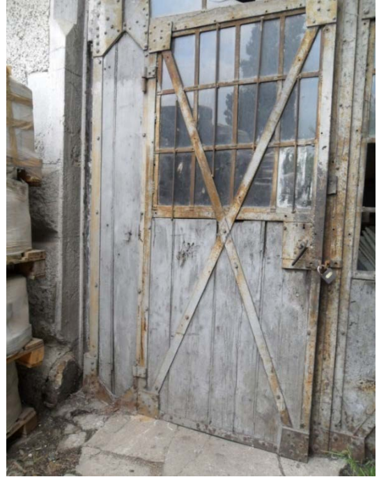
Şekil 5. 222 Arka cephe, 6 nolu hattın bulunduğu bölümün devamındaki ofis binasının orijinal kapısının detayı
