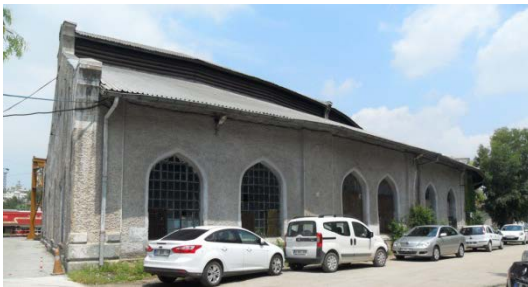
Şekil 5. 237 Yan ve arka cephe, 13, 14 ve 15 nolu hattın bulunduğu bölüm, çatı ve çatı aydınlığı
