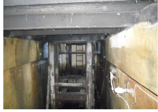
Şekil 5. 103 İç mekân, 11, 12, nolu hattın bulunduğu bölüm, lokomotif bakım çukurları arasındaki kaydırma sistemi
