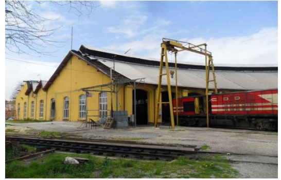
Şekil 5. 161 Lokomotif Giriş Cephesi, 14 nolu hattın bulunduğu bölümün yan cephesi, çatı kaplama malzemesindeki kayıplar, çatı konstrüksiyonu ve çatı aydınlığı
