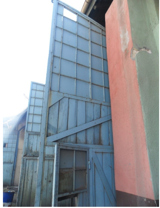
Şekil 5. 75 4 nolu hattın bulunduğu bölümün lokomotif giriş – çıkış kapısı
