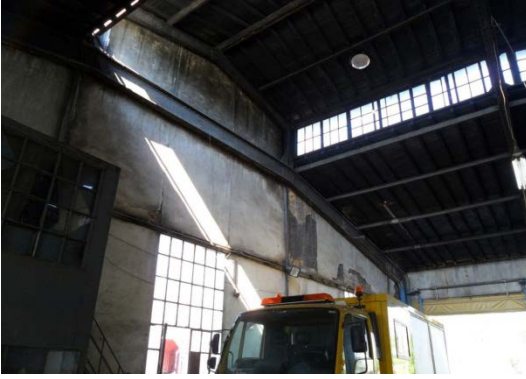
Şekil 5. 49 İç mekân, 1 nolu hattın bulunduğu bölüm, yan duvar, ön duvar ve kapı boşluğu, çatı ve çatı aydınlığı
