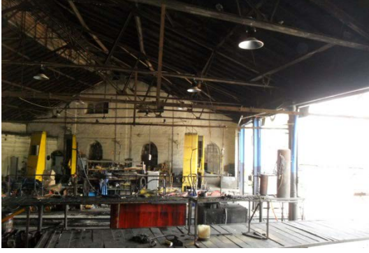
Şekil 5. 244 İç mekân, 2 - 13 nolu hattın bulunduğu bölümler, 13 nolu hattın bulunduğu bölümün yan duvarı, ana mekânın çatısı ve çatı aydınlığı detayları
