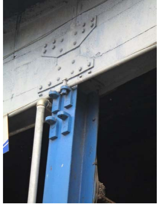
Şekil 5. 230 Ön cephe, lokomotif giriş-çıkış kapıları arasındaki çelik taşıyıcının kiriş ile birleşme detayı
