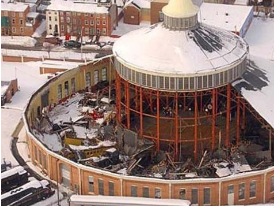
Şekil 4. 12 B&O Ulaşım Müzesi. Çatının çökmesi, 2003 [67].
