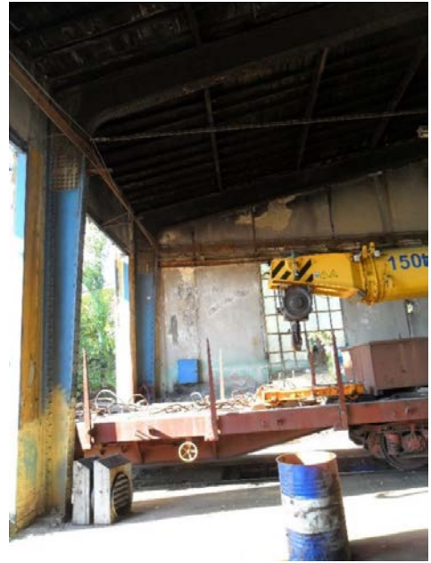
Şekil 5. 46 İç mekân, 9 hattın bulunduğu bölüm, ön cephe ve arka cephe duvarlarının iç yüzeyleri ve çatıda devam eden metal iskelet, yan duvar, çatı
