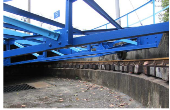
Şekil 5. 34 Krupp marka dönerköprü, beton çukur duvarı, döner köprü döndürme ünitesi, taşıyıcı kirişler
