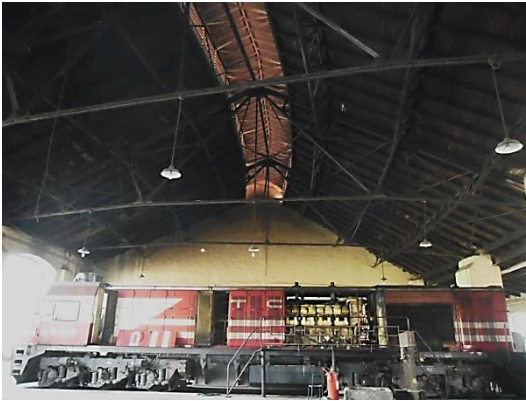
Şekil 5. 100 İç mekân, 10, 11, 12, 13 ve 14 nolu hattın bulunduğu bölüm, çift yönde eğimli kırma çatı ve aydınlık pencereleri
