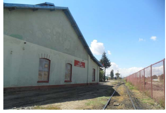
Şekil 5. 71 Yan Cephe, deponun ana mekânını örten ana çatı ve arka cephedeki ikincil mekân ve bu mekânı örten ikincil çatı, değiştirilmiş pencereler.
