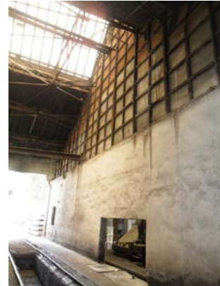
Şekil 5. 255 İç mekân, 3 nolu hattın bulunduğu bölüm, arka cephedeki kapı, bu bölümün çatısı
