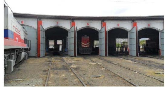
Şekil 5. 280 Ön cephe, 4 - 8 nolu hattın bulunduğu bölüm, lokomotif giriş - çıkış kapıları, taşıyıcı kolonlar
