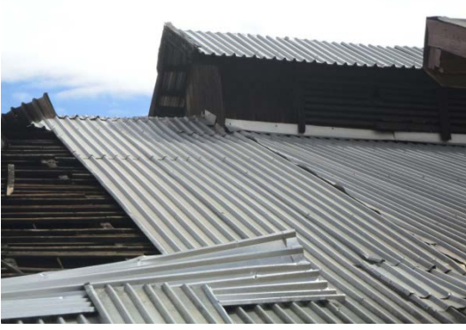
Şekil 5. 168 Ana mekânın çatısı, çatı aydınlığı, çatı kaplama malzemesindeki bozulmalar
