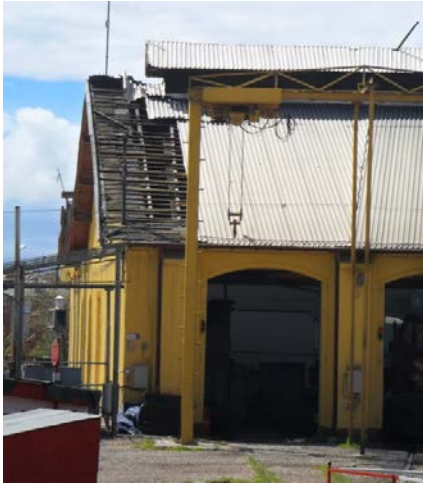
Şekil 5. 160 Giriş Cephesi, 13, 14, nolu hattın bulunduğu bölüm, çatı kaplama malzemesindeki kayıplar, çatı aydınlığı
