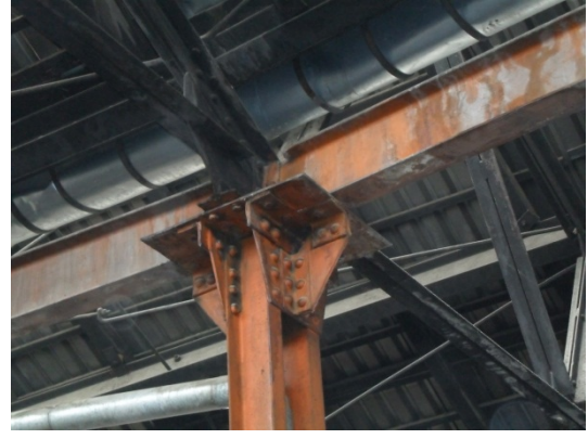
Şekil 5. 189 İç mekân, 12, 13 ve 14 nolu hatların bulunduğu bölüm, çatılara ait konstrüksiyon ve birleşme detayları
