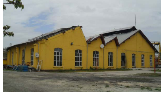
Şekil 5. 163 14 nolu hattın bulunduğu bölümün yan cephesi ve arka cephesi, PVC'den imal edilmiş yeni pencereler, ana mekânın çatısı, çatı aydınlığı ve devamında üç adet kırma çatı, çatı kaplama malzemesindeki kayıplar
