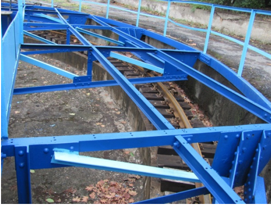
Şekil 5. 33 Krupp marka dönerköprü, beton çukur duvarı, döner köprü döndürme ünitesi, taşıyıcı kirişler
