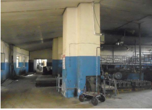
Şekil 5. 104 İç mekân, 15 ve 16 nolu hattın bulunduğu bölüm, taşıyıcı kolonlar ve bu mekânın üzerini örten çatı altı kaplaması
