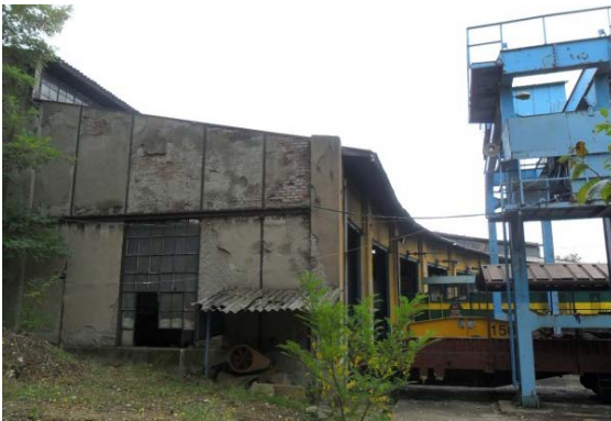
Şekil 5. 29 Ön ve yan cephe, 5, 6, 7, 8, 9 nolu hatların bulunduğu bölümler, kapı açıklıkları, metal iskelet - tuğla duvar örgüsü şeklinde imal edilmiş duvar
