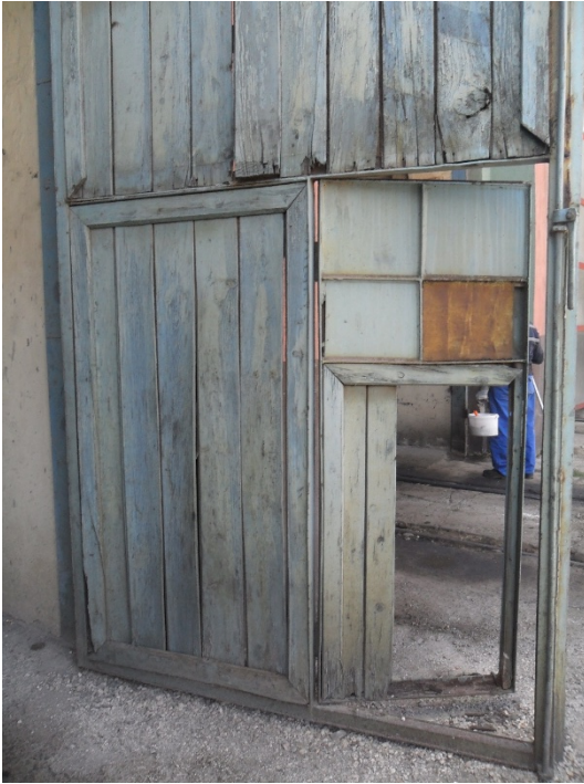
Şekil 5. 76 4 nolu hattın bulunduğu bölümün lokomotif giriş – çıkış kapısı
