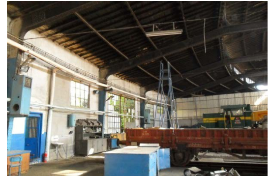
Şekil 5. 42 İç mekân, 4, 5, 6, 7 nolu hatların bulunduğu bölüm, duvarlarının iç yüzeyleri ve çatıda devam eden metal iskelet, arka duvar, bölücü duvar, çatı
