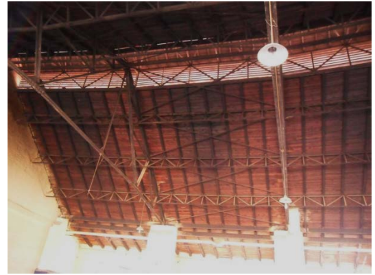
Şekil 5. 101 İç mekân, 10, 11, 12, 13 ve 14 nolu hattın bulunduğu bölüm, çift yönde eğimli kırma çatı ve aydınlık pencereleri
