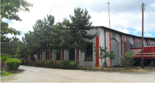
Şekil 5. 301 Ön ve yan cephe, 9, 10, 11, 12 nolu hattın bulunduğu bölüm, yan cephedeki orijinal pencereler, taşıyıcı kolonlar
