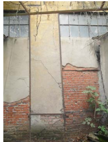
Şekil 5. 30 Arka cephe, tuğla duvar örgüsü, duvarlardaki bozulmalar, pencereler
