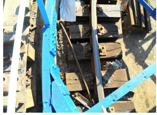
Şekil 5. 32 Krupp marka dönerköprü, beton çukur duvarı, döner köprü döndürme ünitesi
