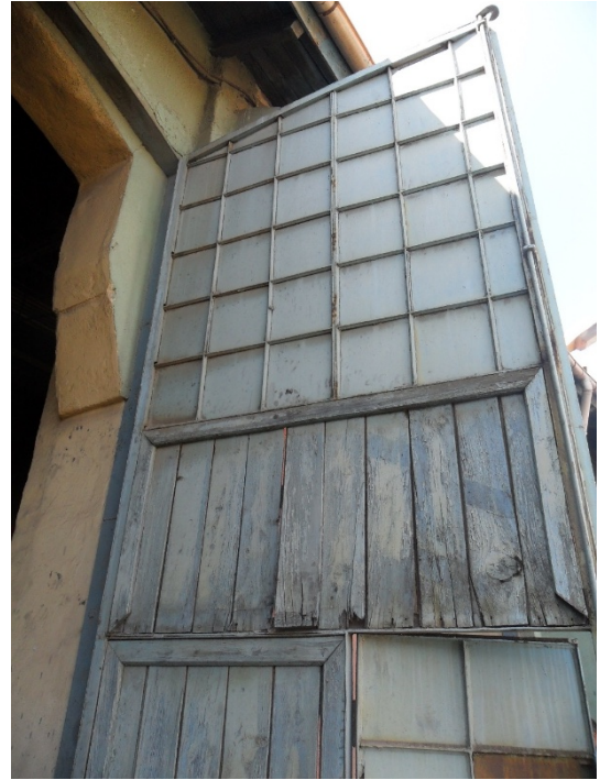
Şekil 5. 77 4 nolu hattın bulunduğu bölümün lokomotif giriş – çıkış kapısı
