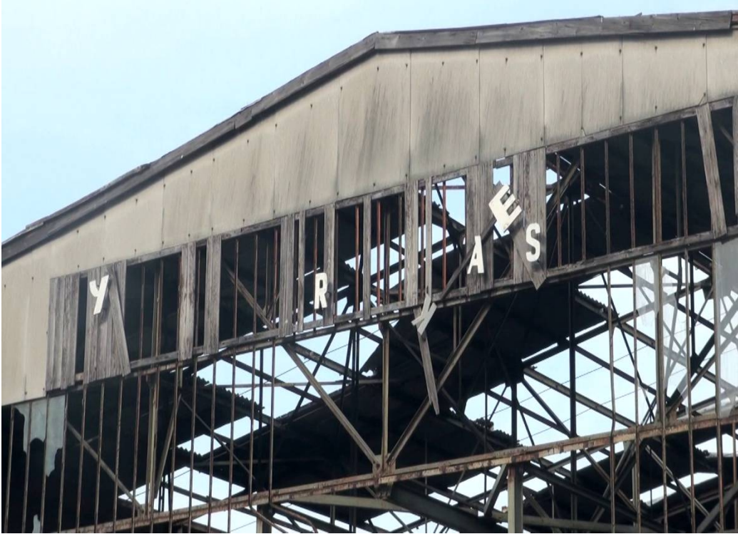
Resim-100-101: Ayancık'taki eski Kereste Fabrikası'nın metruk binası ve bina üzerindeki harfler
