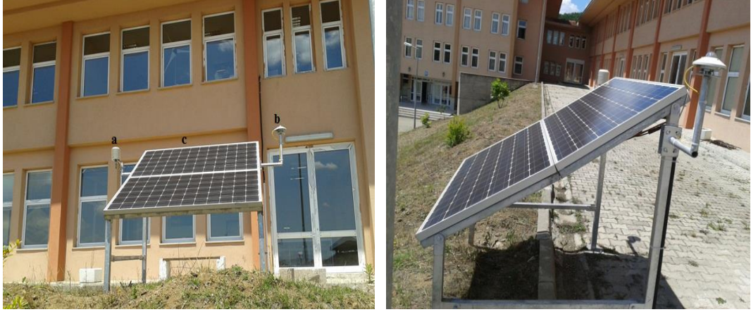
Şekil 8.2. FV paneller (a) Sıcaklık ve nem sensörü, (b) Işınım sensörü, (c) FV paneller
