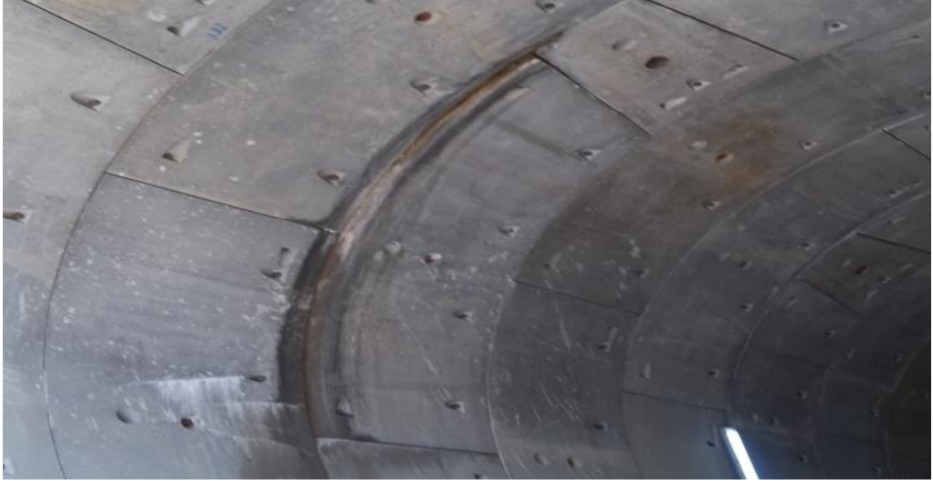
Şekil 4.6: Segment taşlarından açığa çıkan su sızıntısı.
