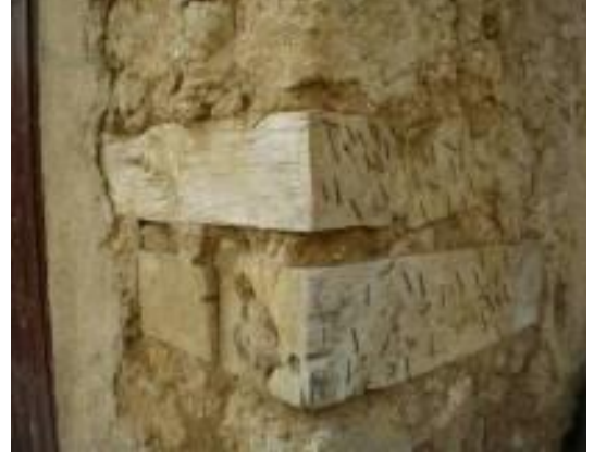
Resim 5.6: kötü durumda olan duvar (AbdAllah , Mart 2009)
