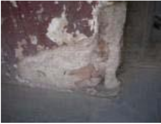
Resim 5.5: kötü durumda olan duvar (AbdAllah , Mart 2009)
