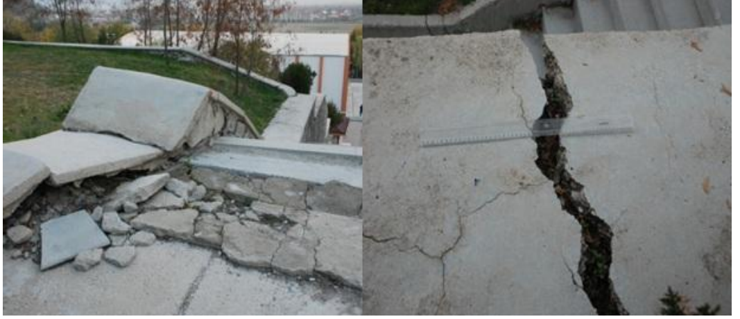
Şekil 1.2. İnceleme alanında gözlenen çatlaklar ve hasarlar
