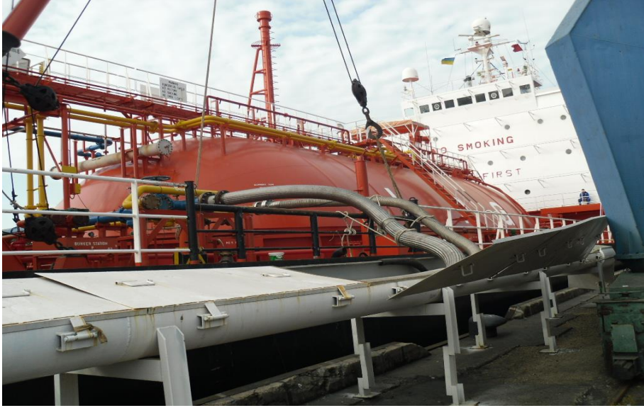
Şekil 4.5 : Tanker-terminal arası emniyetsiz manifold sahası.
