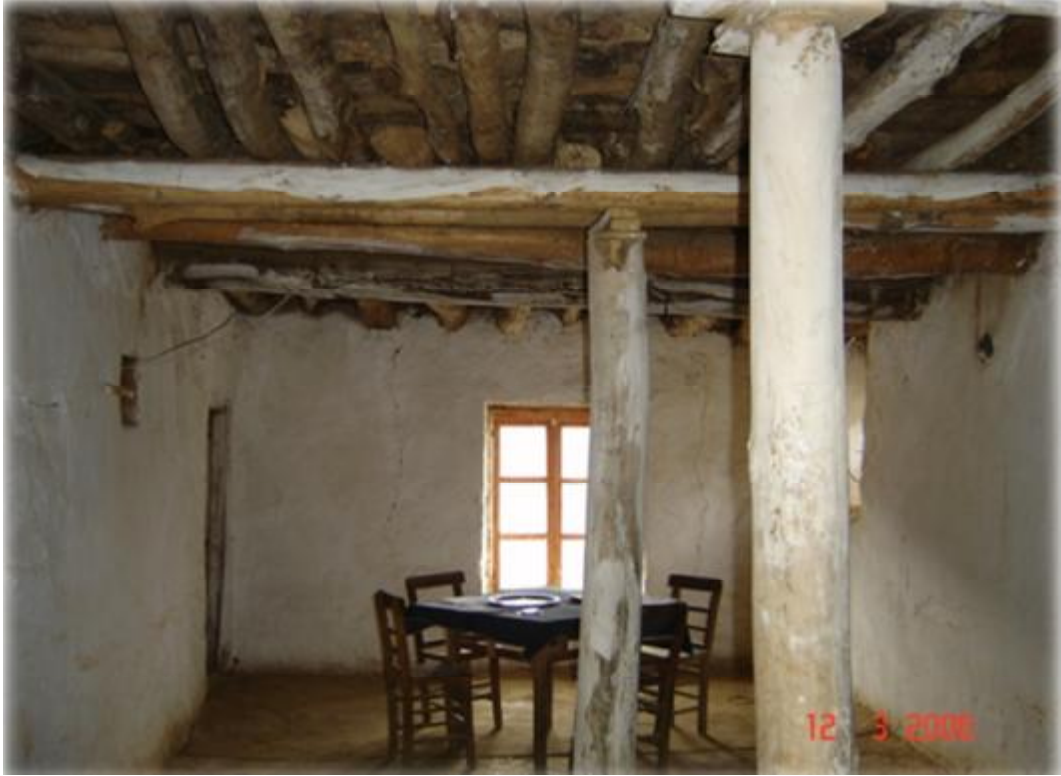
Şekil 2.5. Elazığ-Sivrice ağır hasarlı köy odası
