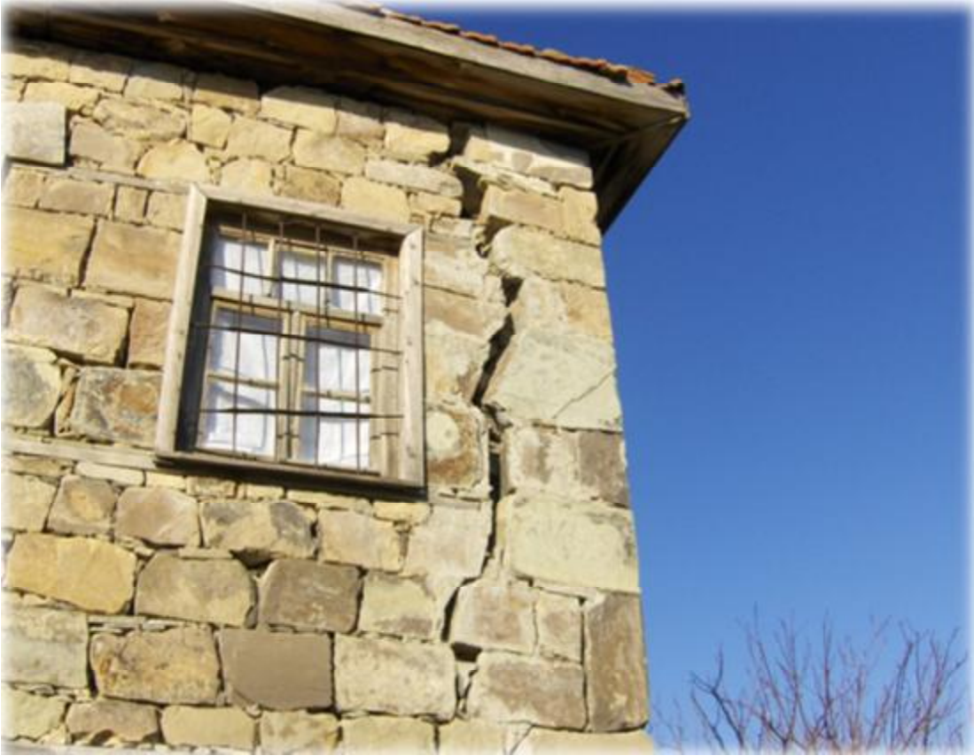
Şekil 1.1. Ağır hasarlı Köy Konutu Ankara - Bala -Yeniyapançarsak köyü
