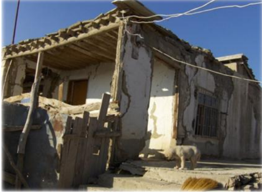
Şekil 1.2. Ağır Hasarlı Köy Konutu Ankara-Bala-Yeniyapançarsak köyü
