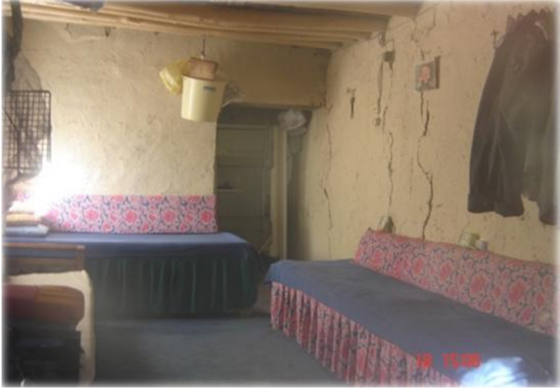
Şekil 2.3. Ağrı-Doğubayazıt ağır hasarlı köy konutu
