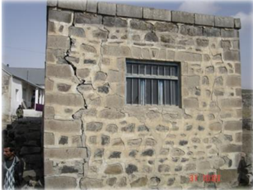
Şekil 4.7. Ağrı-Tutak ağır hasarlı köy konutu
