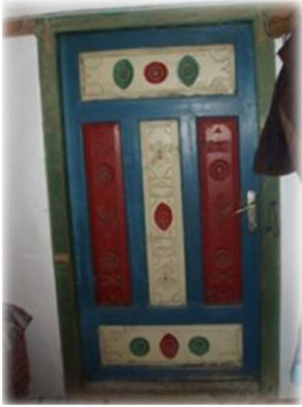
Şekil 5.7. Ağır hasarlı konut kapı detayı
