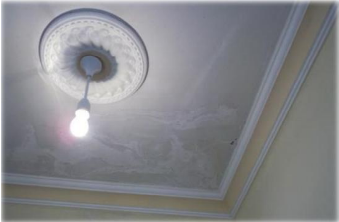
Şekil 4.27. Yeni konuttaki sorunlar (iç mekan)
