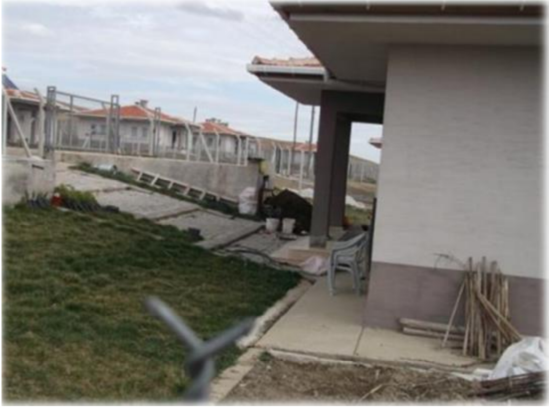
Şekil 4.28. Yeni konuttaki sorunlar (dış mekan)
