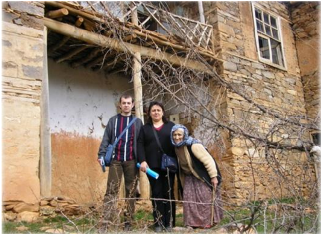
Şekil 2.4. Malatya-Pütürge ağır hasarlı köy konutu
