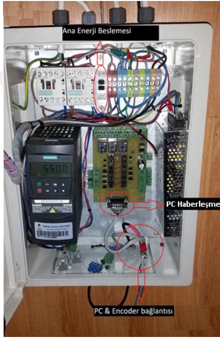
Şekil 4.15 T60 kubbe kontrol panosu
