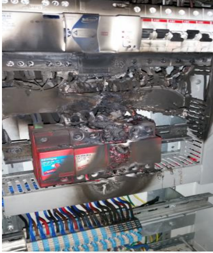
Şekil 4.13. Yıldırım deşarjında zarar gören T100 Enerji dağıtım panosu
