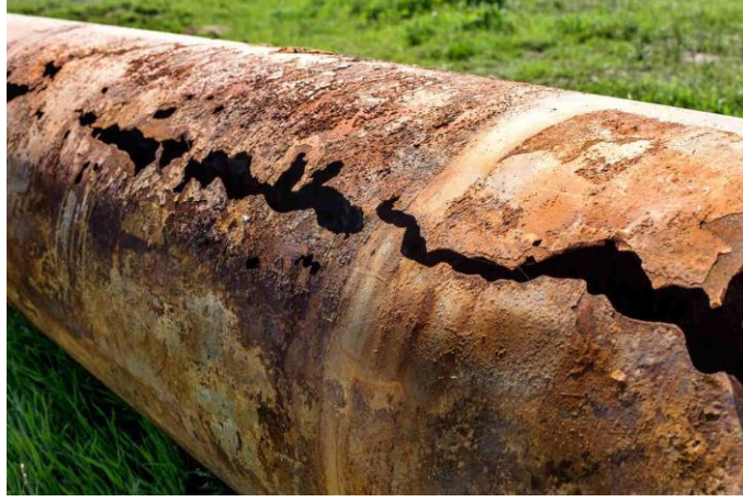
Şekil 2.Çukur korozyona uğramış metal yüzey [9]
