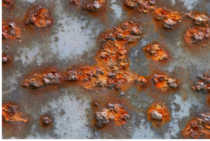
Şekil 6. Taneler arası korozyona uğramış metal yüzey[18]
