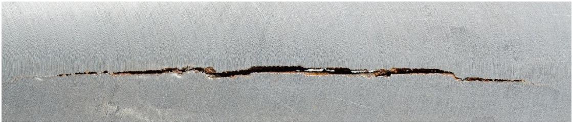
Şekil 9. Hidrojen kaynaklı çatlama sonucu korozyona uğramış metal yüzey [22]
