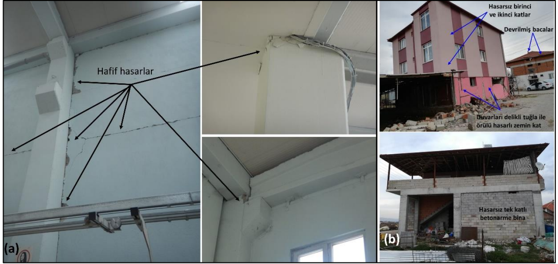
Şekil 6.47(a): Yassıhöyük mahallesinde betonarme prefabrik fabrika yapısındaki hafif hasarlar, (b) Apa mahallesinde zemin katı ağır hasarlı üç ve hasarsız tek katlı betonarme yapılar (Kumsar ve diğ. 2020).
