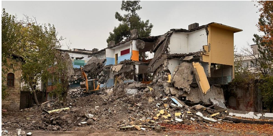
Şekil 4.60. Gaziantep Cumhuriyet İlkokulu Deprem Sonrası Görünüm (1)
