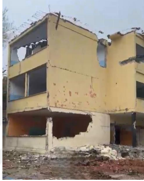
Şekil 4.61. Gaziantep Cumhuriyet İlkokulu Deprem Sonrası Görünüm (2)
