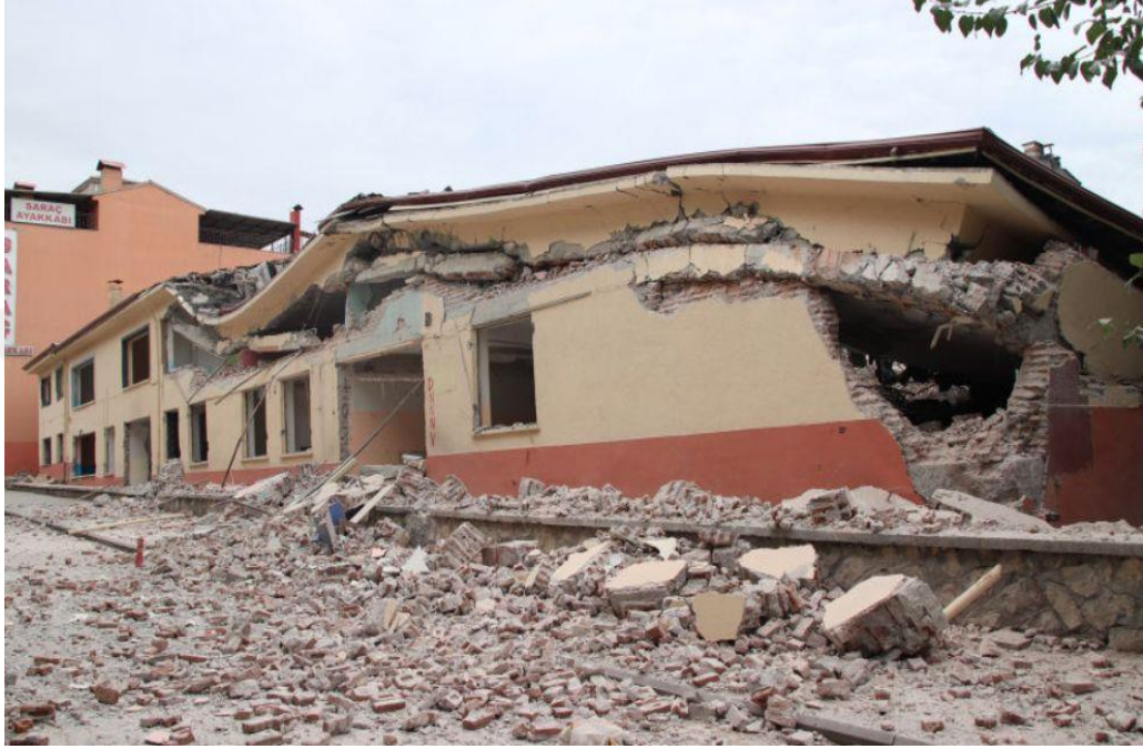
Şekil 4.26. Derme İlkokulu Deprem Sonrası Görünüm (2)
