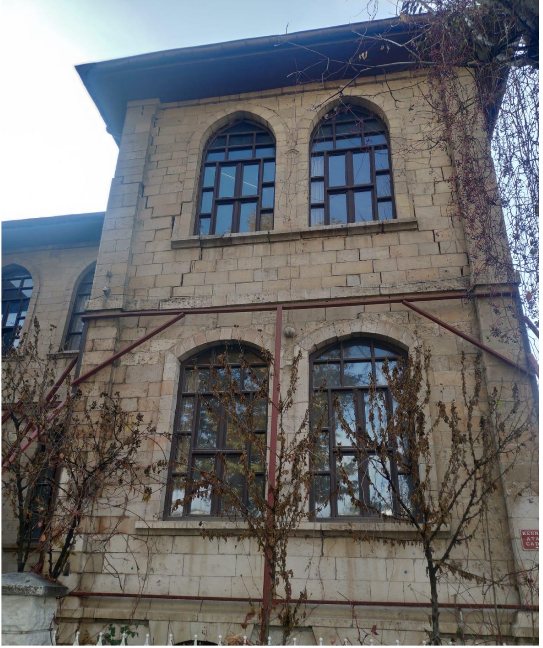
Şekil 4.16. Taş Mektep – Gazi İlkokulu Deprem Sonrası Görünüm (2)
