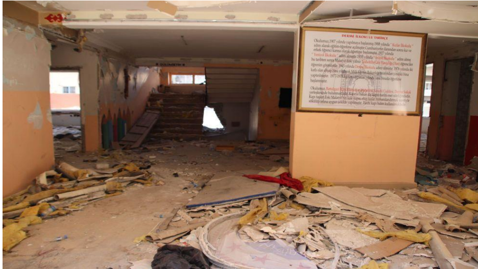
Şekil 4.25. Derme İlkokulu Deprem Sonrası Görünüm (1)
