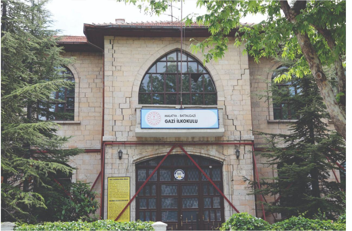
Şekil 4.15. Taş Mektep – Gazi İlkokulu Deprem Sonrası Görünüm (1)
