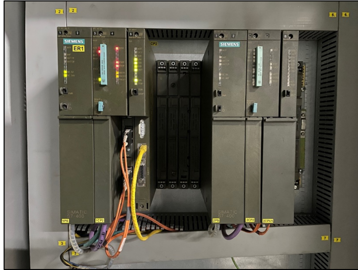
Şekil 6.5 : 4.Slab Fırını redundant ısıtma PLC sistemi.
