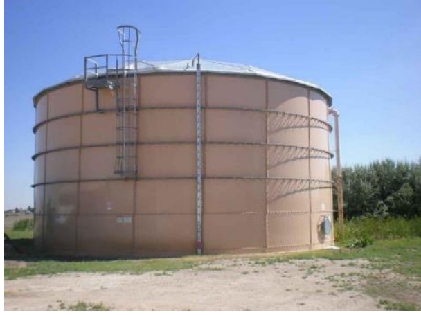
Şekil 3.15. Yer düzeyinde bulunan tank (CST, 2024)
