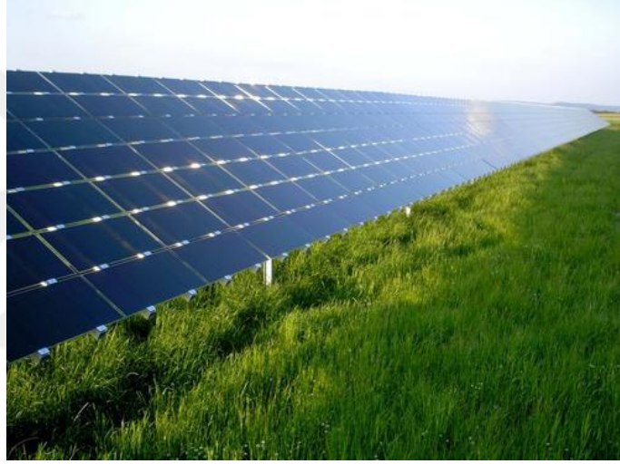
Şekil 3.9. CdTe Panellerden oluşan pv dizisi [26]
