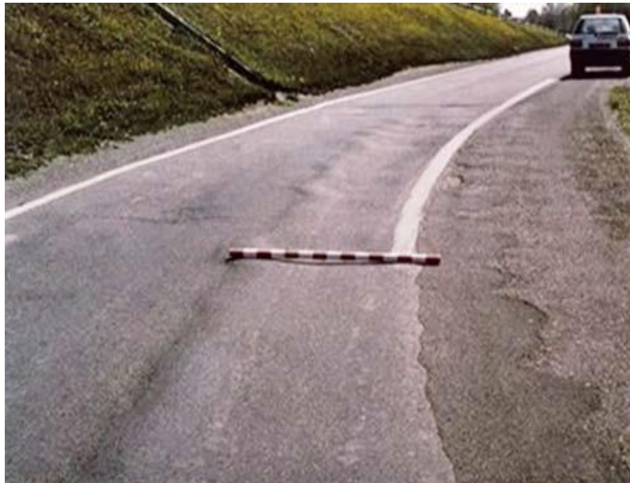
Şekil 1. 4 Kaplamalarda tekerlek izi oluşumu örneği [5]
