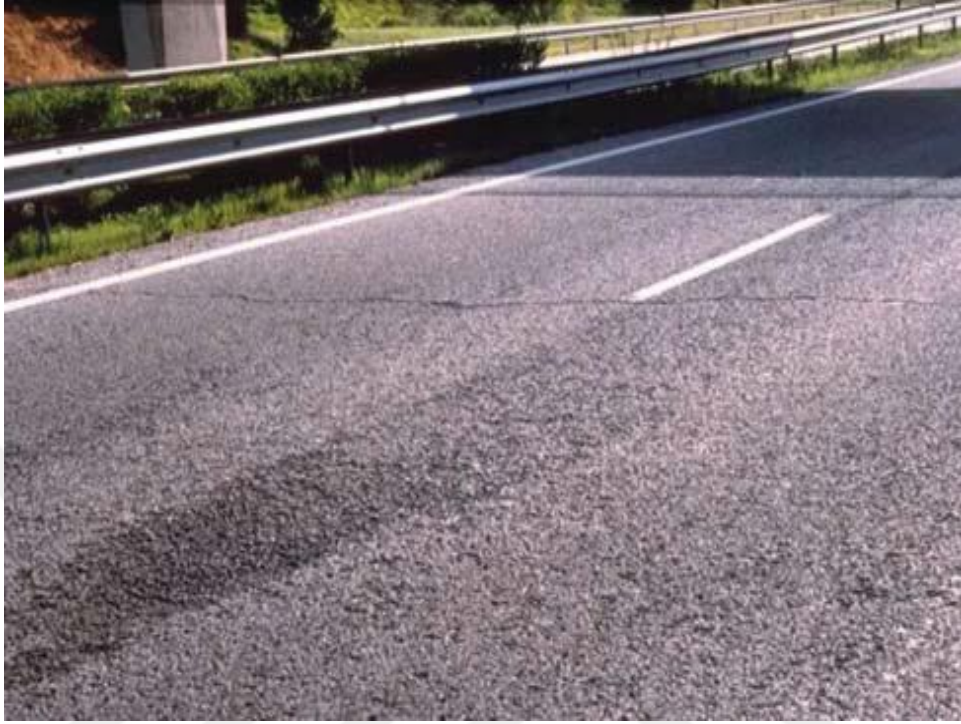
Şekil 1. 1 Nem hasarı sonucu oluşan soyulma problemi örneği [5]
