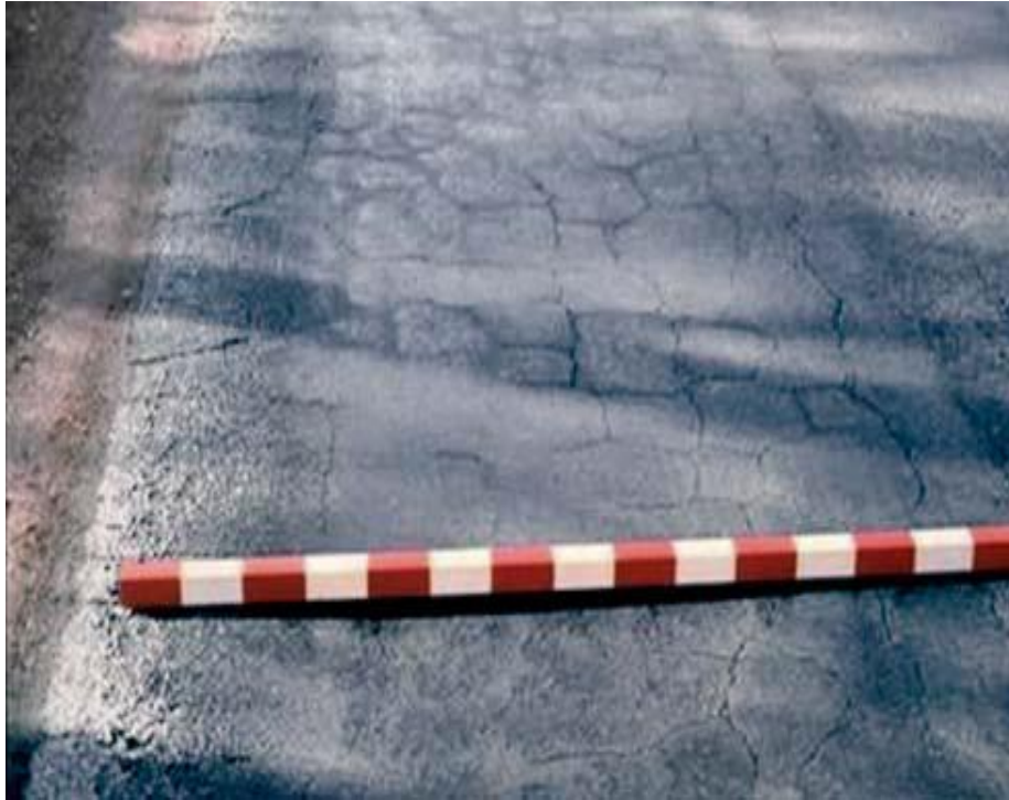
Şekil 1. 6 Yorulma çatlak problemi örneği (timsah sırtı çatlak) [5]
