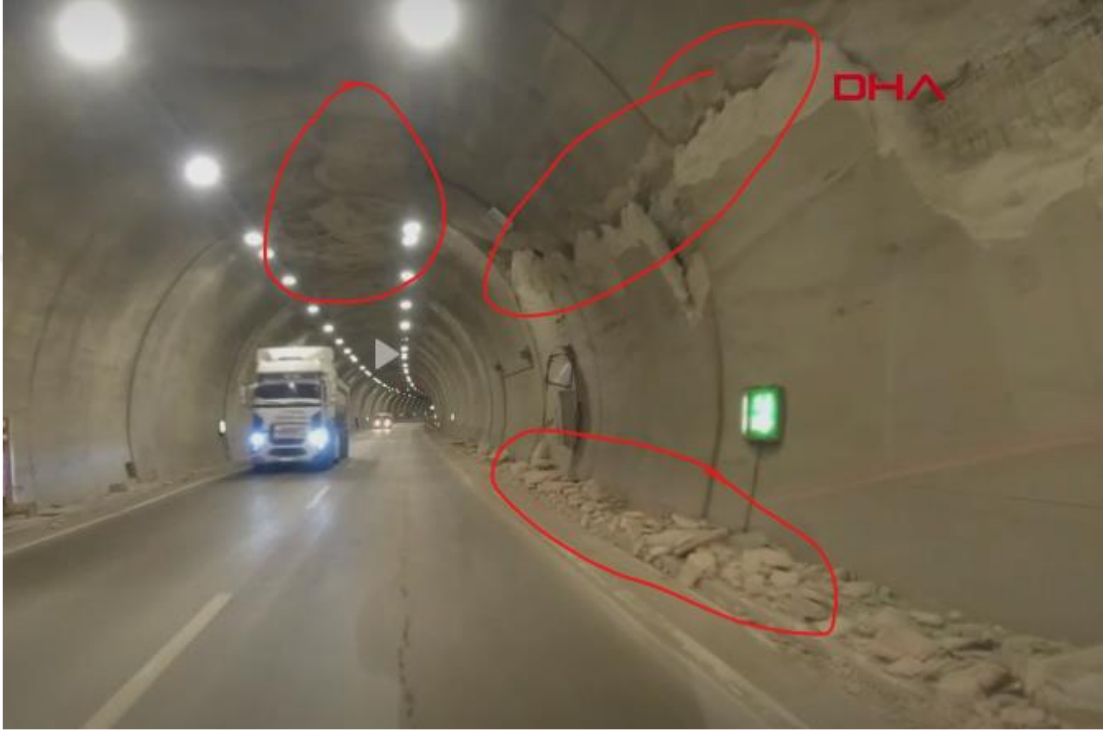
Şekil 43. Kahramanmaraş depremi sonrası tünellerde oluşan zararlar
