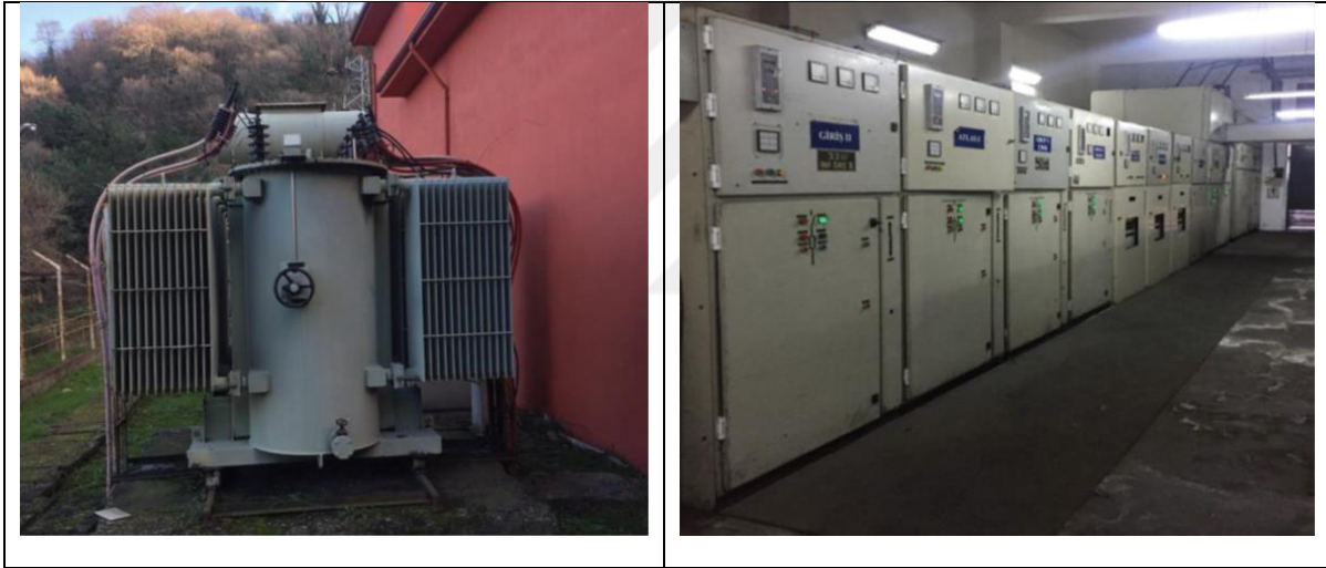
Şekil 2.18 Yerüstü transformatör ve yüksek gerilim devre kesicileri (TBMM 2023).
