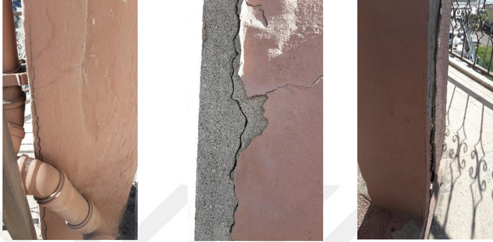
Şekil 5.3. Yapıda meydana gelmiş hasarlar
