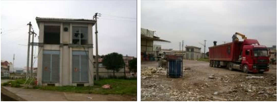
Resim 5.10 Tehlike oluşturabilecek elektrik ve gaz
