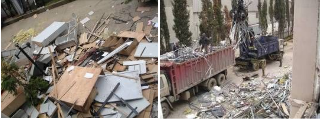
Resim 5.7. Yapı yıkımında ayrıştırmaya özen gösterilmemesi
