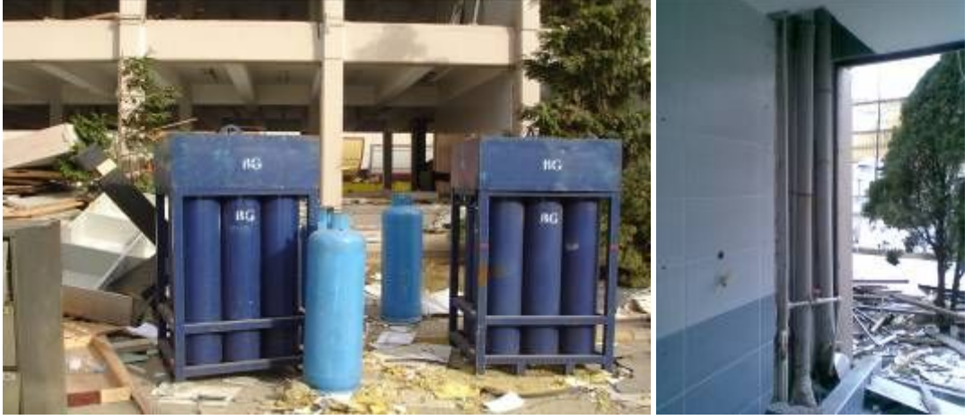
Resim 5.6. Tehlike oluşturabilecek gaz ve su bağlantıları inşaat mahallinde
