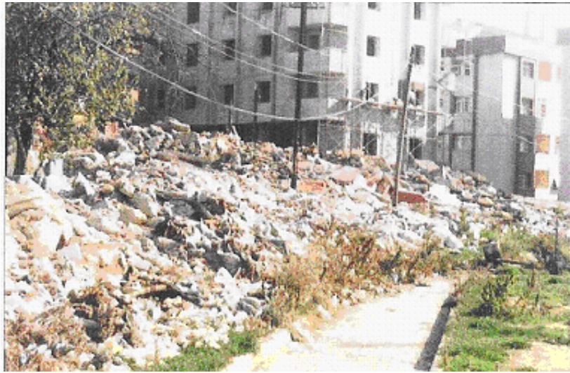
Resim 2.5 İnşaat yıkıntı atığı kirlenmesi [Öztürk,2005].
