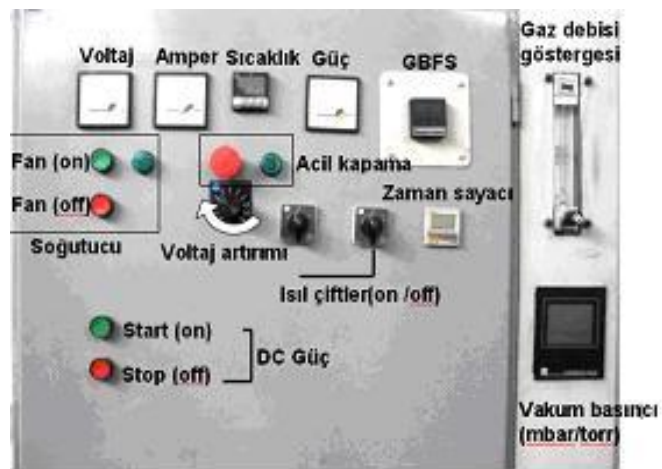
Şekil 3.8. Göstergeler, düğmeler ve ledlerin kontrol panosundaki yerleşimi.
