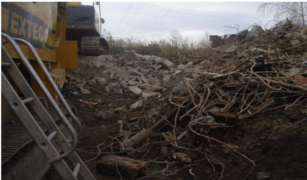
Resim 2.2. Betondan ayrılmış demirin görüntüsü (Ateş, 2008).
