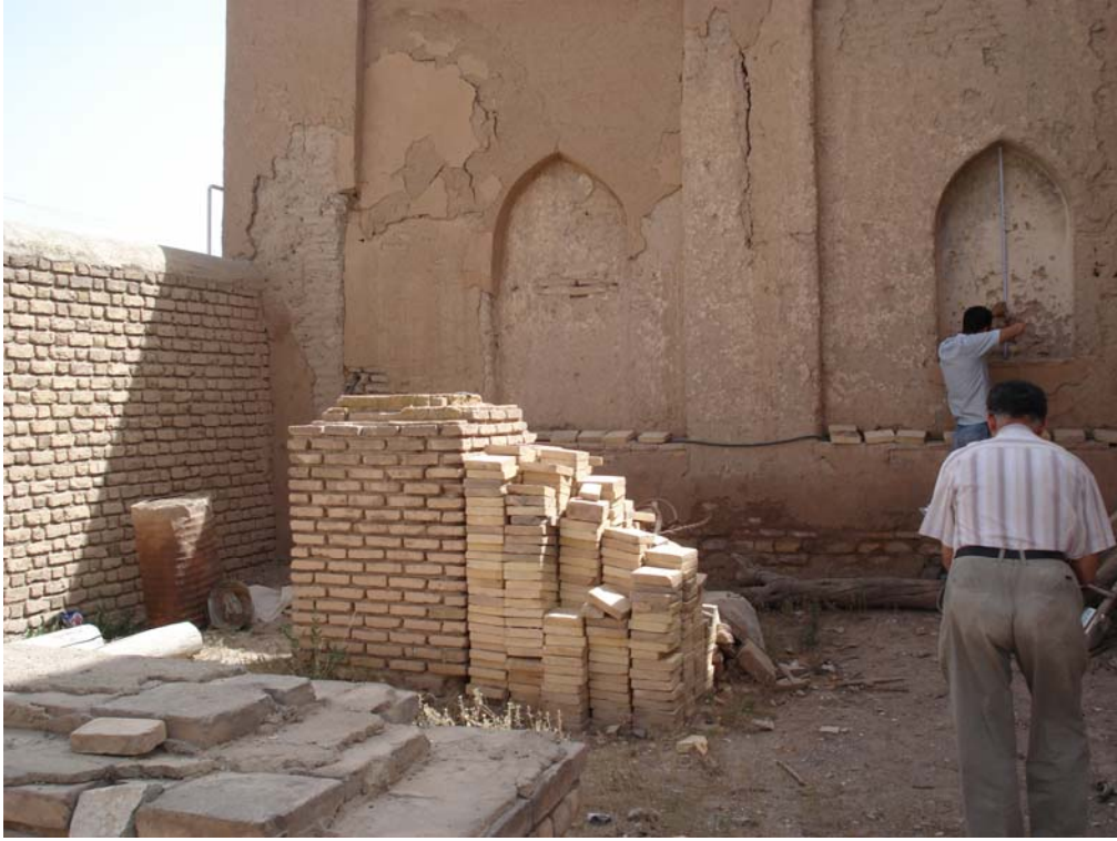
Resim 3.50. Yapının kuzey cephesinde sıva dökülme örnekleri [SOBOUTI, H., 2007]
