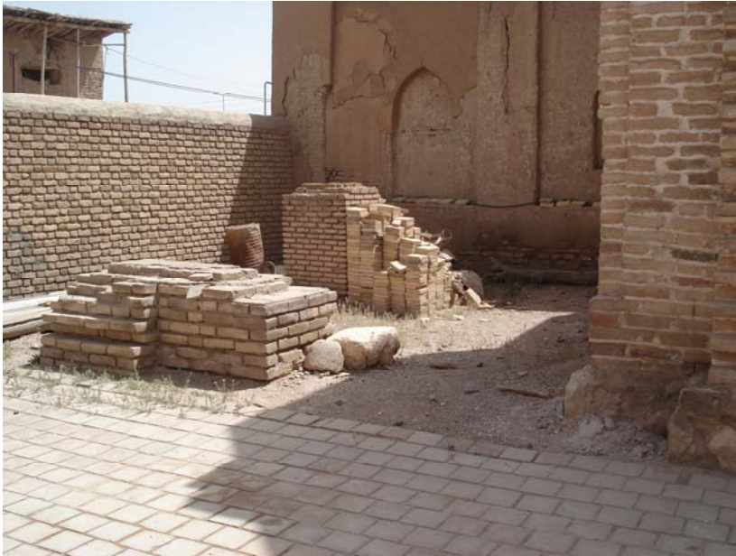
Resim 3.59. Batı iç cephede eyvan kalıntısı
