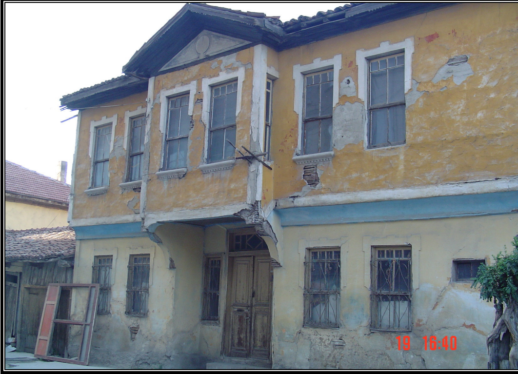
Fotoğraf 3.50. Eski Bozüyük evlerinin bir kısmı restore edilirken, bir kısmı da bakımsızlıktan dolayı, harabe olmaya terk edilmiştir.
