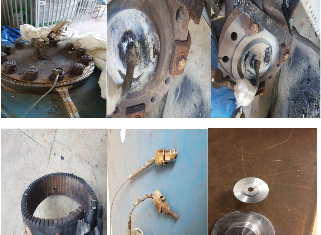
Şekil C.3 Sistemi işletirken yaşanan problemlere örnekler (reaktör, rezistans, termokapıl, regülatör)
