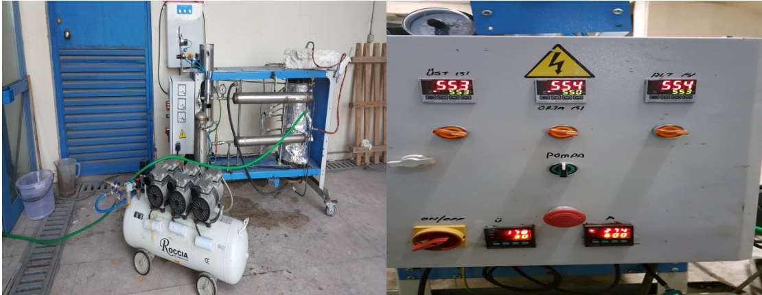
Şekil C.1 Sistem ve kontrol panosu
