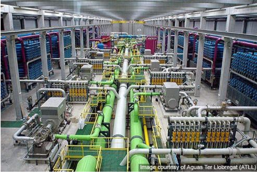
Şekil 4.6. İspanya - Barselona tuzdan arındırma tesisinin içeriden görünüşü
