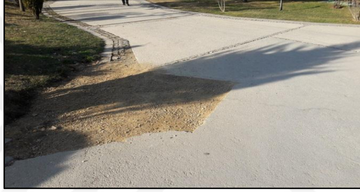
Şekil 4.6 Çökme nedeniyle oluşmuş zemin bozuklukları (Orijinal 2018)
