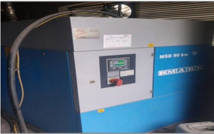
Resim 3.7. 90 kW Güce sahip yedek Kompresör
