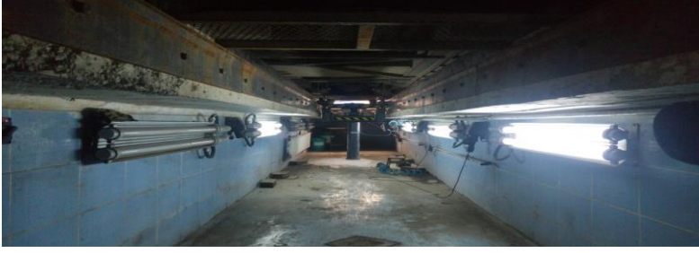
Resim 3.9. Atölye kanal içi aydınlatma görüntüsü
