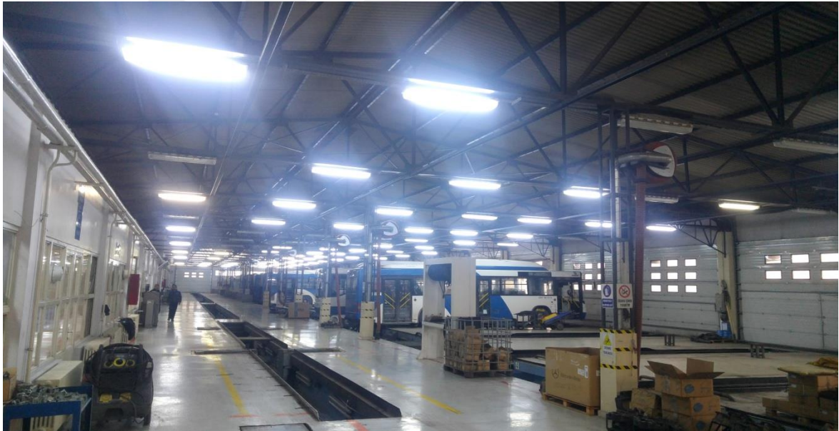
Resim 3.8. Atölye ana binası tek kanat tavan aydınlatması görüntüsü
