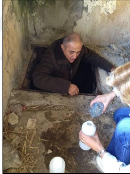
Şekil 5.14 Sarıoba (TPSO-1) sıcak su kaynağı kaptajı
