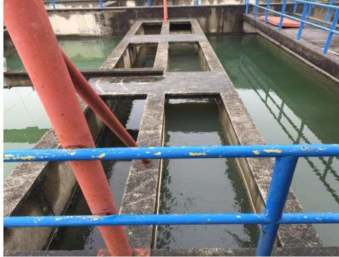
Şekil 4.4. Arıtma tesisinde durultucuya giren su
