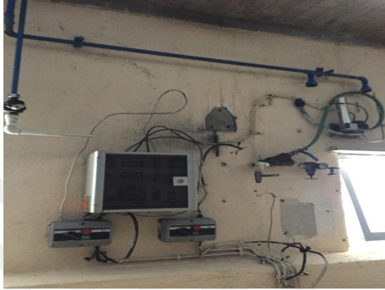
Şekil 4.1. Kontrol odası elektrik panosu
