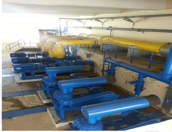
Şekil 4.5. Geri yıkama pompa odası
