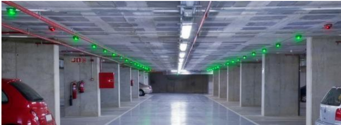
Resim 5.1. Otopark içi sensör uygulaması örneği [30]
