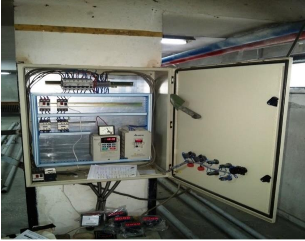
Şekil 3.13 Denemede kullanılan iletim tesisinin kumanda paneli ve dijital gösterge
