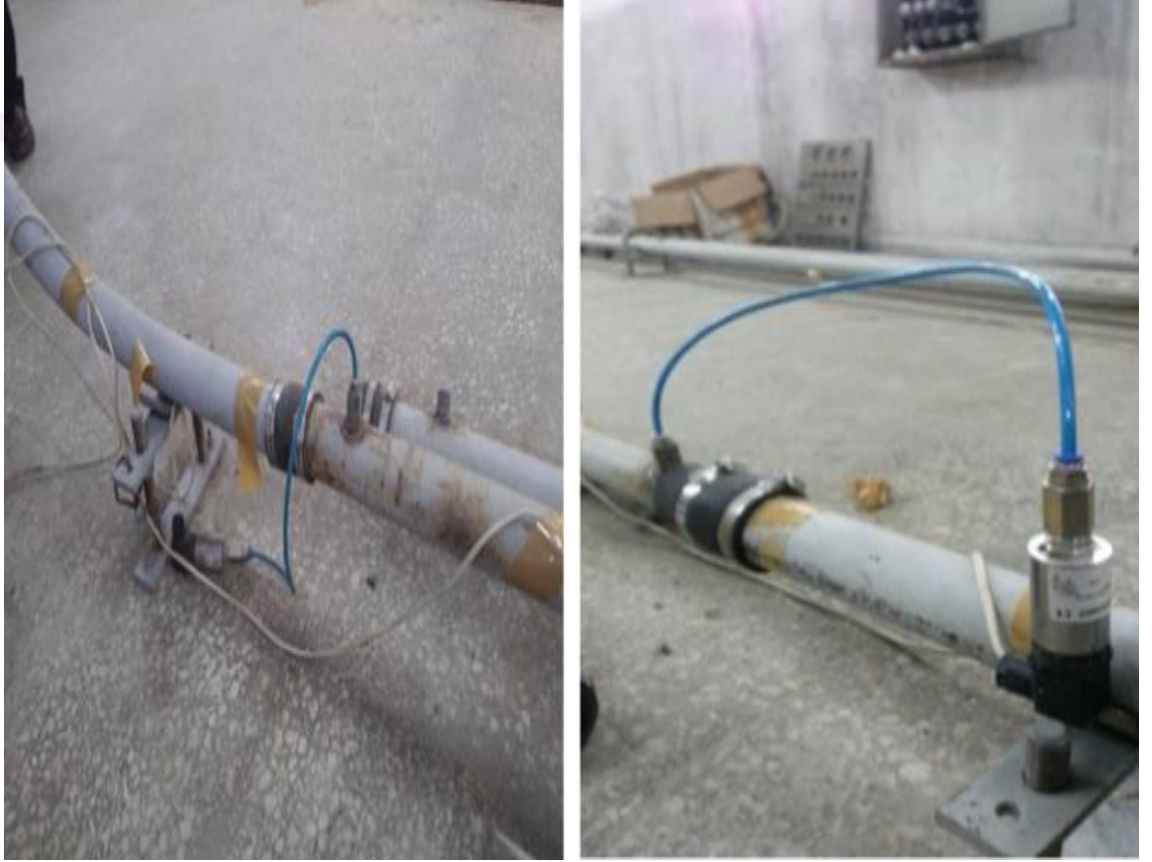
Şekil 3.15 Denemede kullanılan iletim tesisinde, basın sensörleri ve transmitterler
