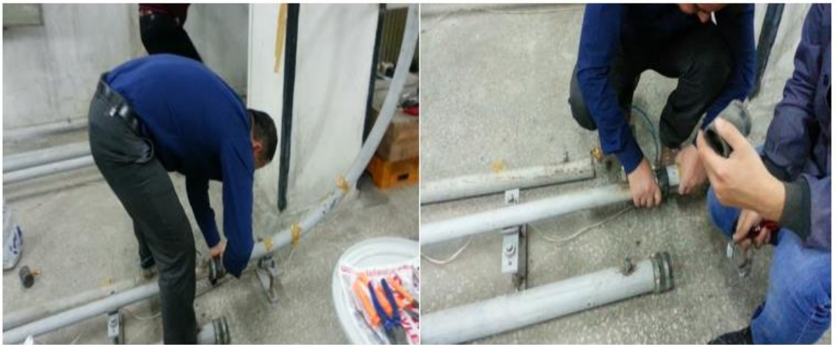
Şekil 3.5 Denemede kullanılan iletim tesisinin denemeye ve ölçümlere hazırlanışı
