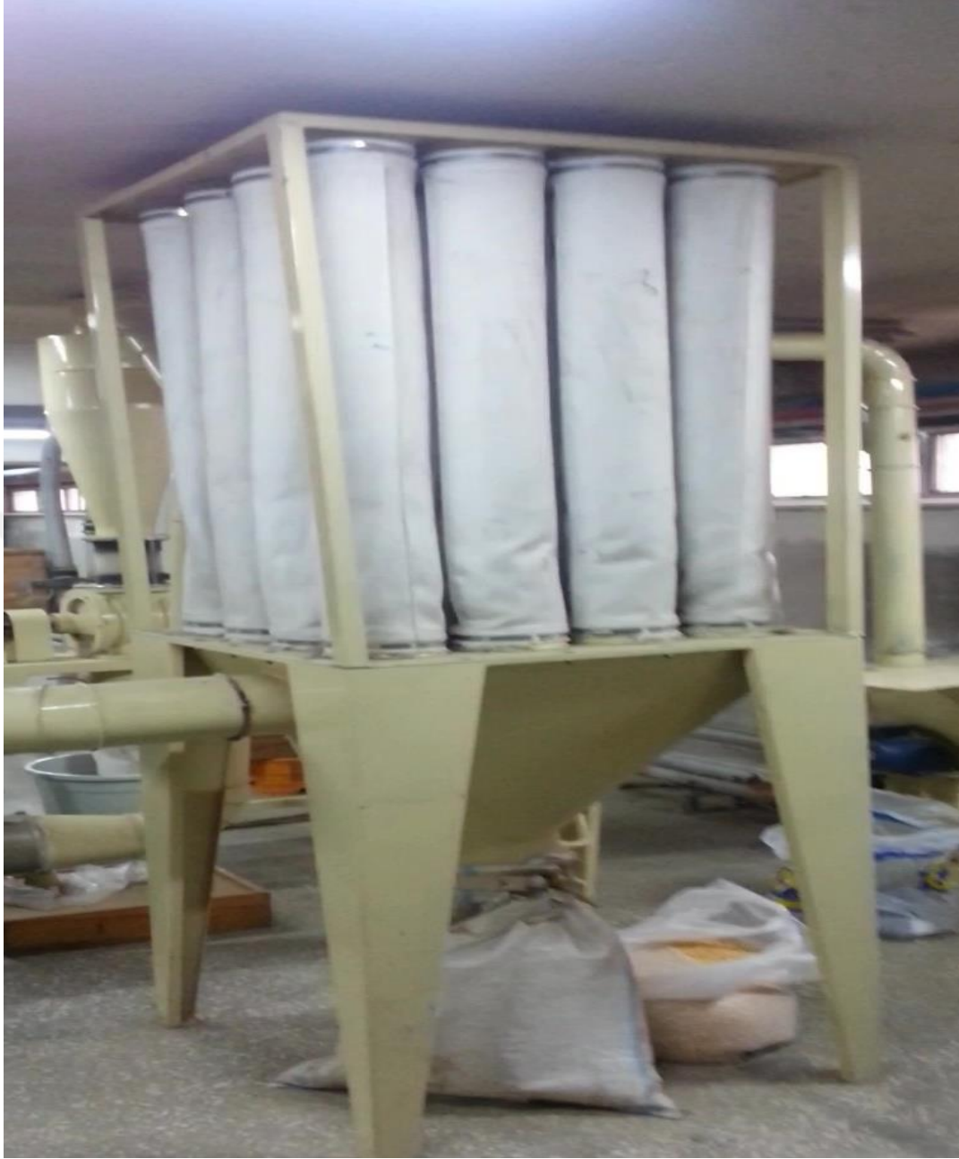
Şekil 3.12 Denemelerde kullanılan pnömatik iletim tesisindeki sanayi tipi toz filtreleme düzeneği ve torba filtre elemanı
