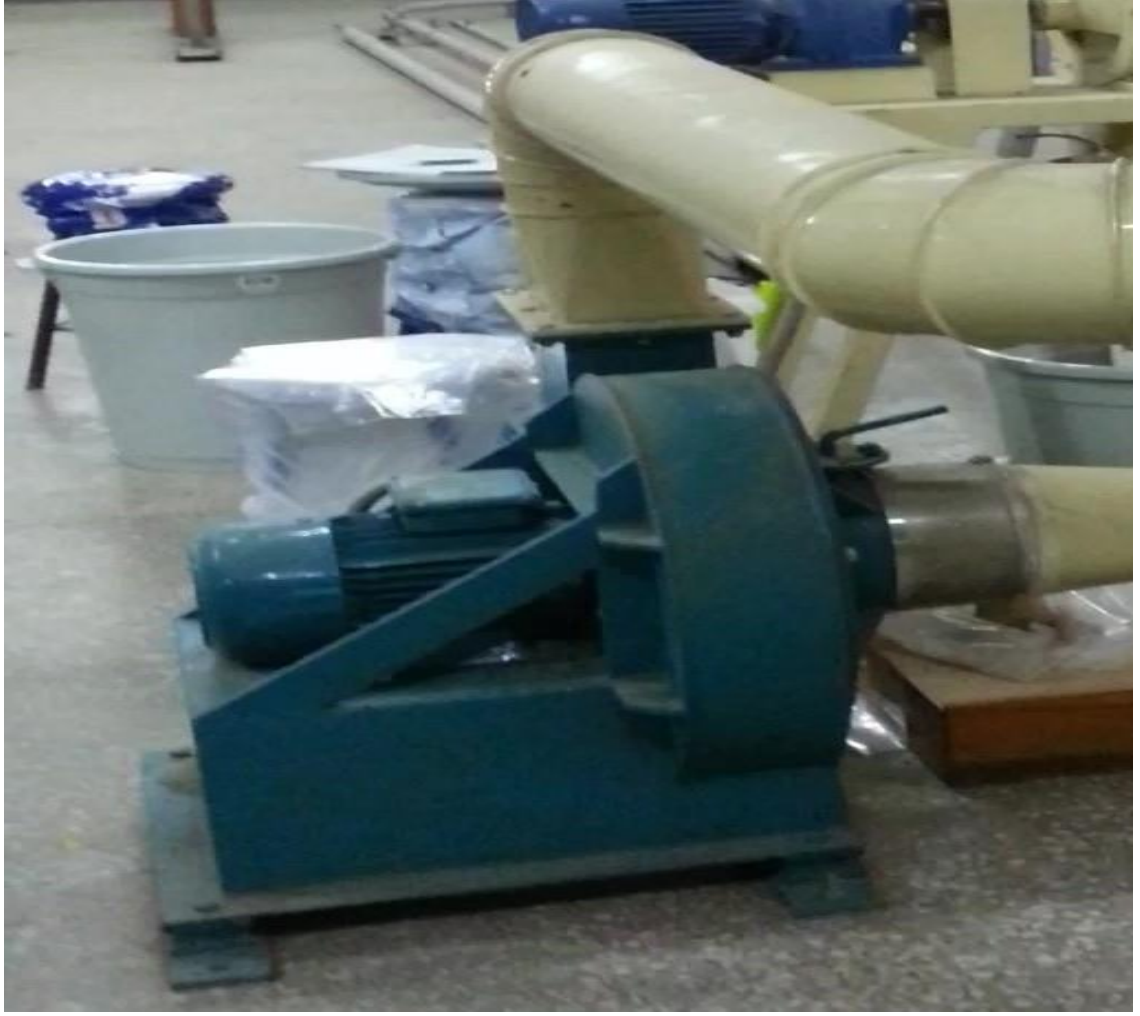
Şekil 3.11 İletim tesisinde kullanılan aspiratör
