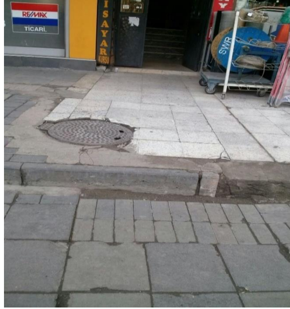
Resim 111: (ŞÇK) Bina önü kaldırım kot farkı
