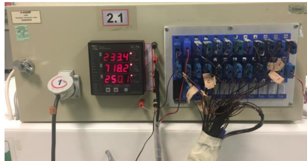
Şekil 4. 8 Veri toplama istasyonu
