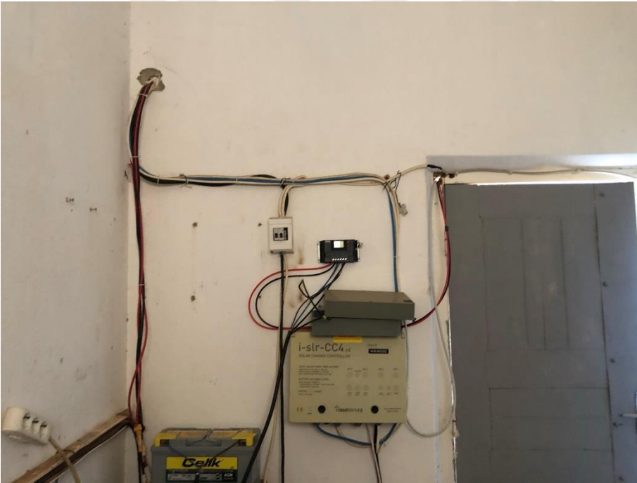
Şekil D. 32 : Atölye mahalli avlu duvarı elektronik panolar
