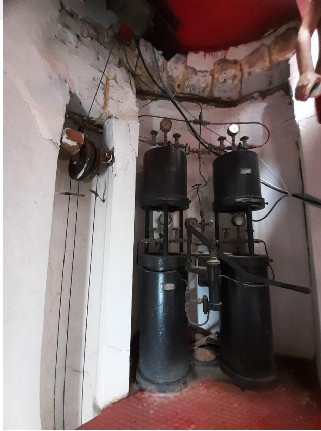
Şekil D. 34 : Fener kulesindeki makine katı, makara ve pistonlar.
