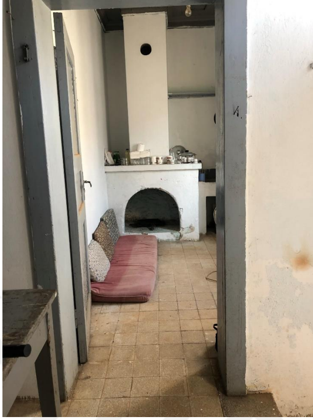
Şekil D. 15 : Mutfak (G03) mekanına giriş kapısı ve içerisinde bulunan ocak.
