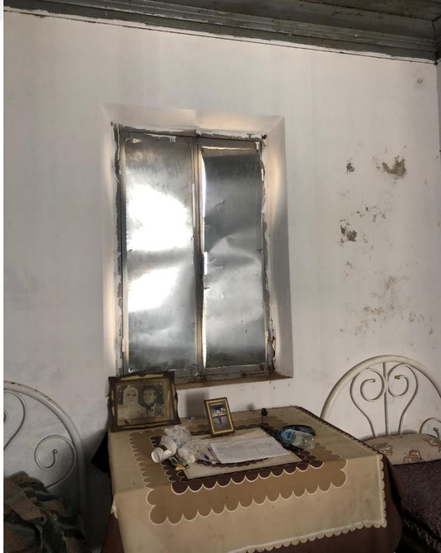
Şekil D. 20 : G05 numaralı mekân ve güneye bakan, metal levha ile kapatılmış penceresi.
