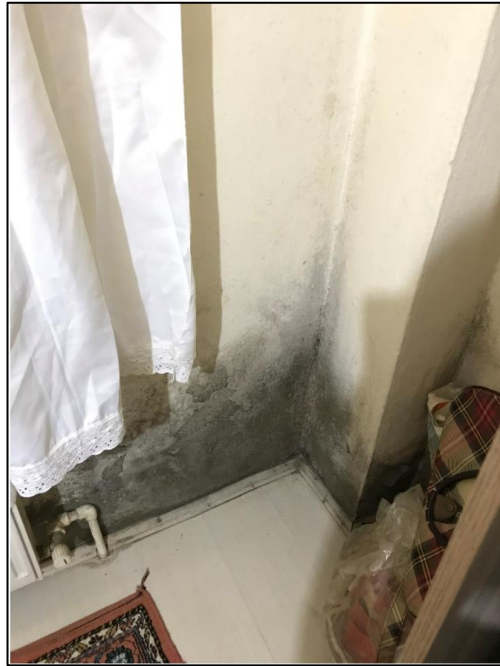
Őekil 8.5 : Duvarların alt kısmında kf mantarı istilası.
