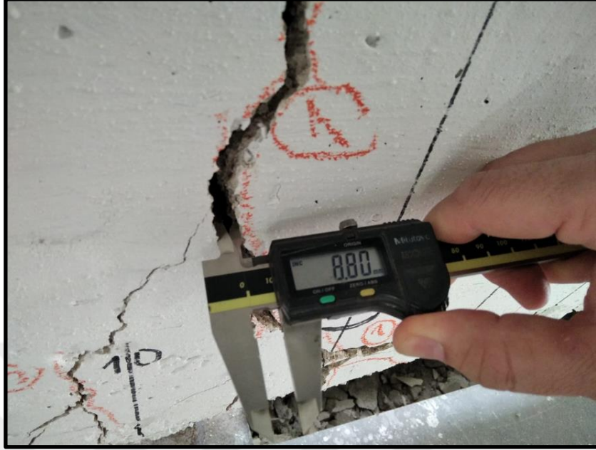
Şekil 3.12. K2 kirişinde (döşeme donatılı) çatlak ölçümü
