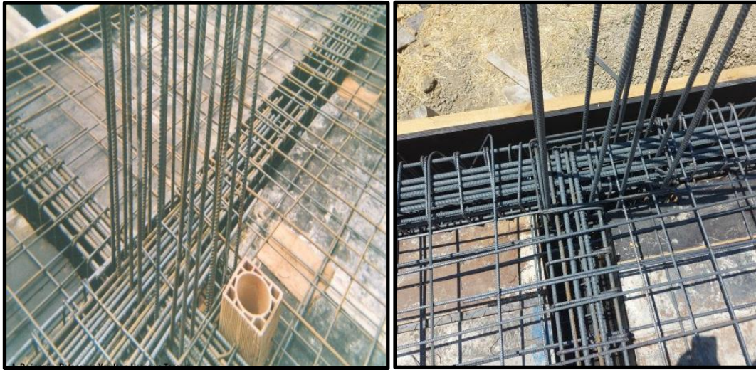
Şekil 1.9. Kolon-kiriş birleşim bölgesinde oluşan donatı sıkışması (Yapısor, 2021a)
