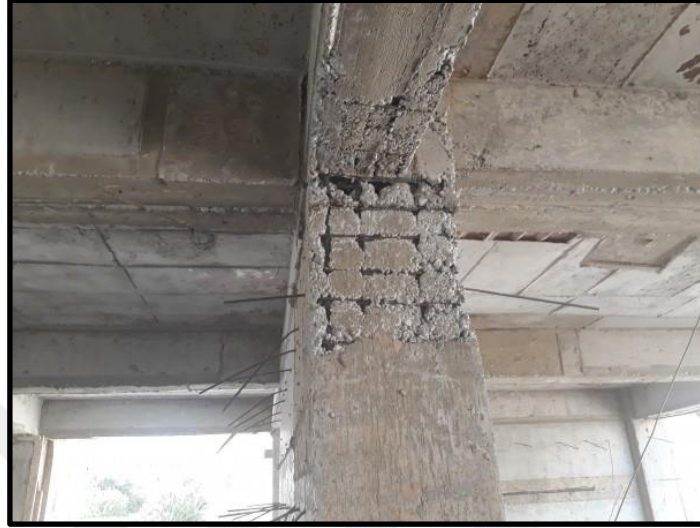
řekil 1.10. Kolon-kiriř birleřim blgesinde oluřan segregasyon (Yapısor, 2021b)
