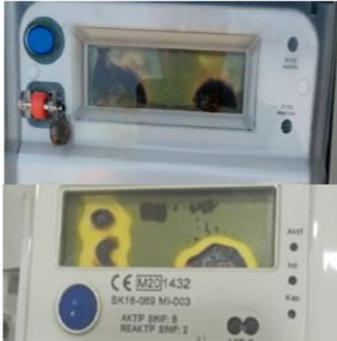
Şekil 3.17. Nötr üzerinde DC gerilim ile sayaca müdahale
