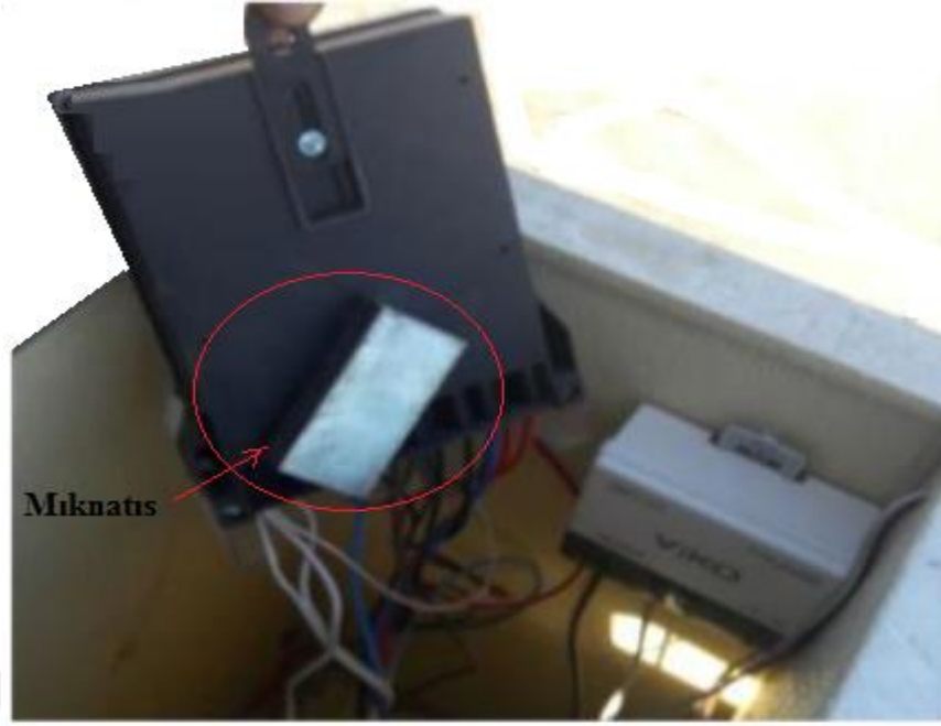
Şekil 3.13. Mıknatıs yöntemi ile kaçak elektrik kullanımı
