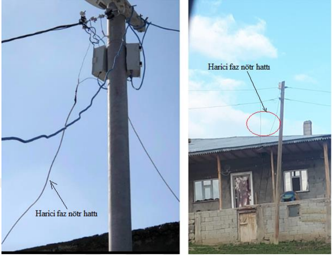
Şekil 3.12. Şebekeden harici faz nötr yöntemi ile kaçak elektrik kullanımı
