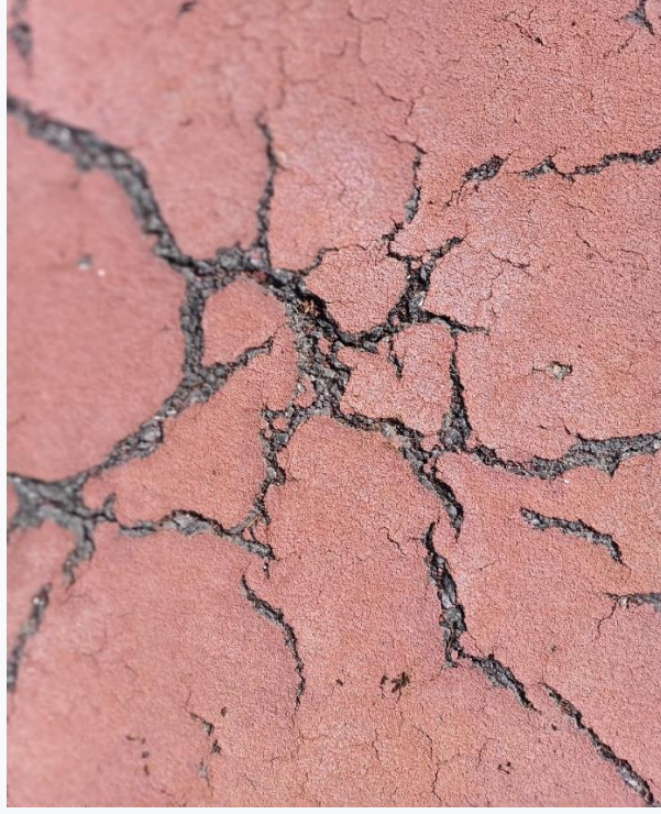
Fotoğraf No 102: Çatlak zemin, Aydan Komi, Haziran 2023.
