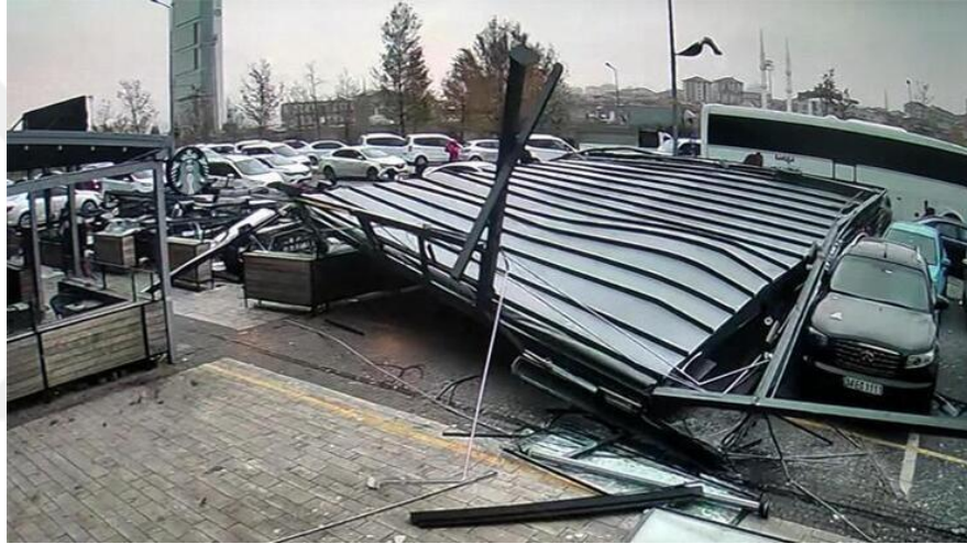
Şekil 1.11. İstanbul'da şiddetli rüzgardan dolayı çöken bir çelik çatı (URL 10)
