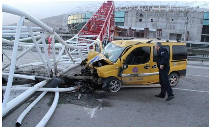
Şekil 1.9. Bursa’da lodosta devrilen bir kule vincin görünümü (URL 8)
