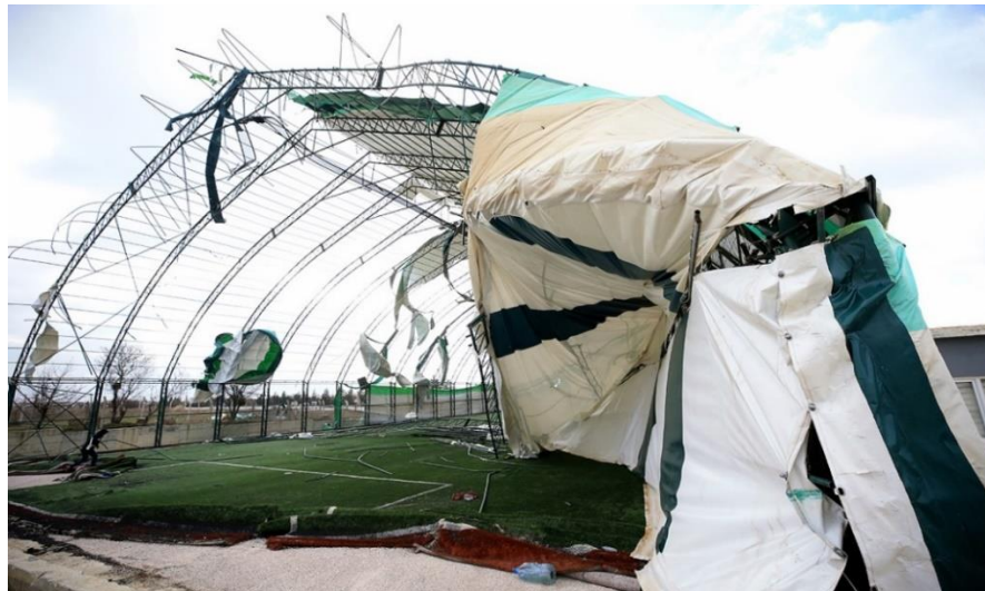
Şekil 1.12. Kırklareli'nde bir halı sahanın, fırtına nedeniyle çelik konstrüksiyonlarında görülen hasar (URL 11)
