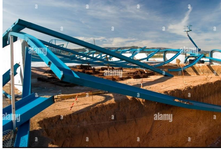
Şekil 1.10. Yapım aşamasında rüzgardan dolayı göçmüş bir çelik yapı (URL 9)
