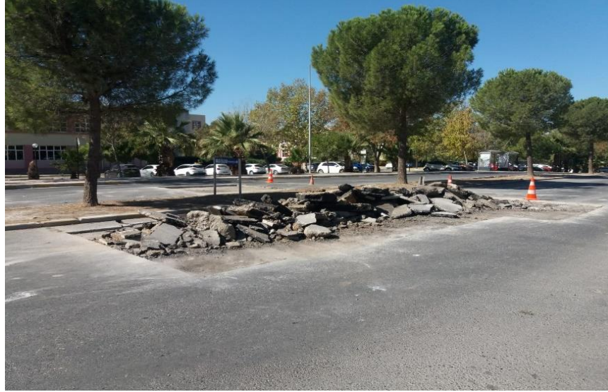
Şekil 4.3 Ağaç köklerinin asfaltta yarattığı tahribat sonucu asfaltın yenilenme çalışması
