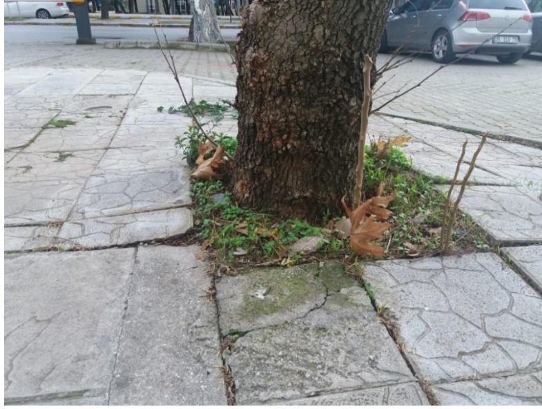
Şekil 1.2 Çınar Ağacı Kök Gelişiminin Kaldırım Döşemesinde Neden Olduğu Deformasyon.
