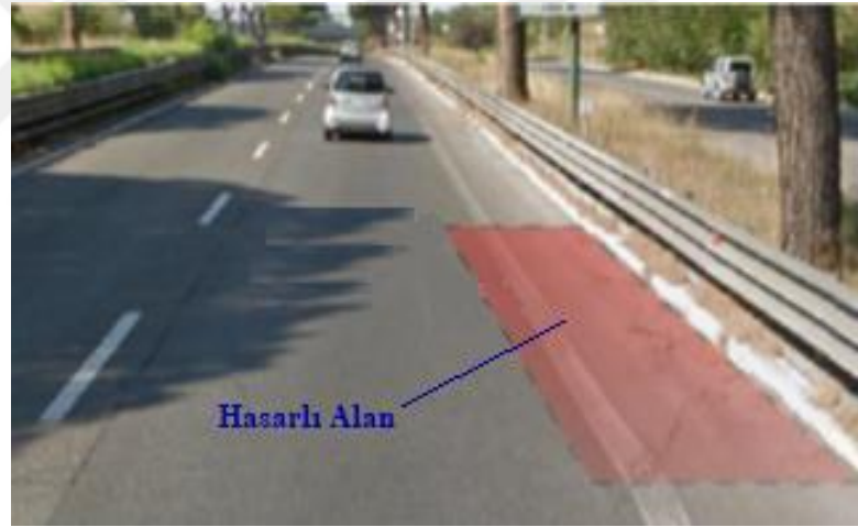
Şekil 1.3 Yanal şeridin kenarında ve eşikte ağaç köklerinin yükselmesi nedeniyle asfalt hasarına bir örnek (Tosti ve diğ., 2018)
