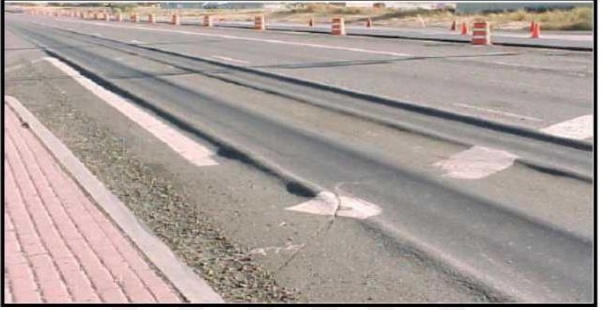
Şekil 21. Tekerlek izi oluşumu
