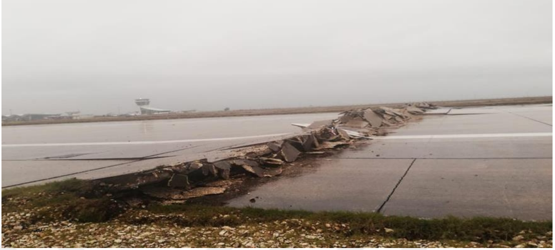
Hatay havalimanında pistte oluşan hasarlar
