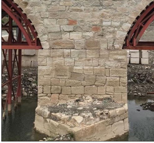
Resim 4.54. Develioğlu Köprüsü Suyun Aşındırıcı Etkisiyle Selyaranda MeydanaGelen Taş Malzeme Kayıpları (Kaya Kişisel Fotoğraf Arşivi, 2023)
