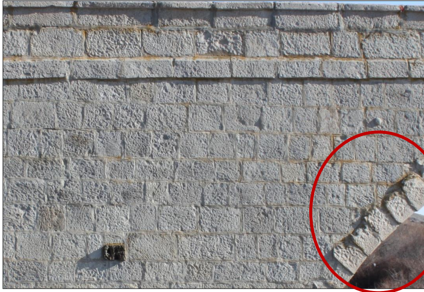
Resim 4.45. Köprüye Ait Kemer Taşlarının Dışarıya Doğru Diş Yapması (KGM Arşivi, Dilaver, 2012:73)
