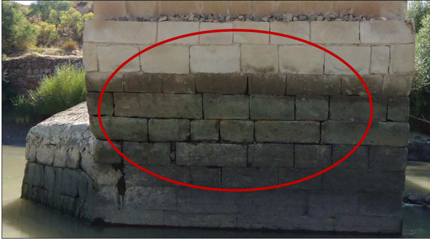
Resim 4.57. Köprü Selyaranlarında Yer Alan Taşları Bağlayan Derz Harçlarında Boşalmalar (KGM Arşivi, Dilaver, 2012:55)
