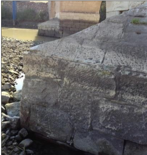
Resim 4.61. Selyaranlardaki Niteliksiz Derz Onarımları (KGM Arşivi, Dilaver, 2012:13).
