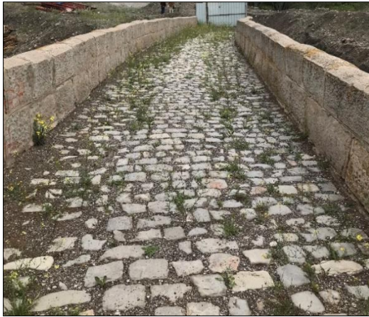
Resim 4.55. Köprü Döşemesi Üzerinde Oluşan Bitkisel Oluşumlar (Kaya Kişisel Fotoğraf Arşivi, 2023)
