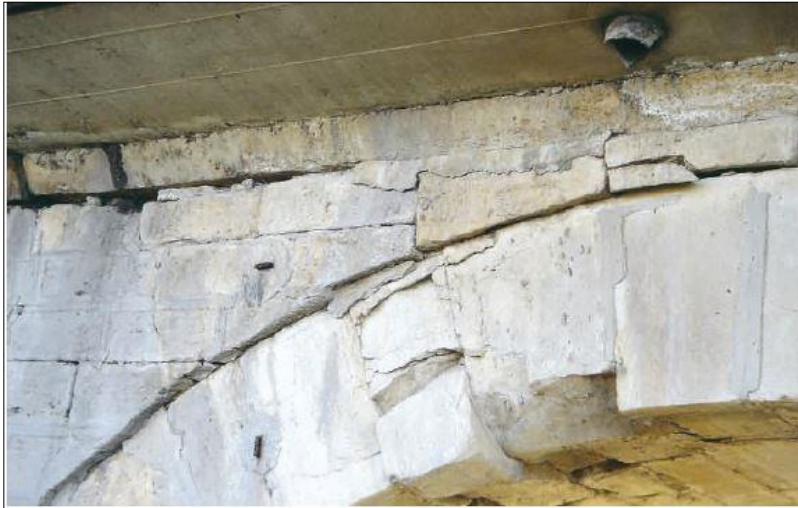
Resim 3.5. Uzunköprü Kemer Deformasyonu (Yüksel, 2009:66)
