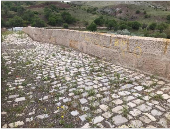
Resim 4.60. Köprü'nün Döşeme Taşları Arasında Görülen Bitkisel Oluşumlar (Kaya Kişisel Fotoğraf Arşivi, 2023)
