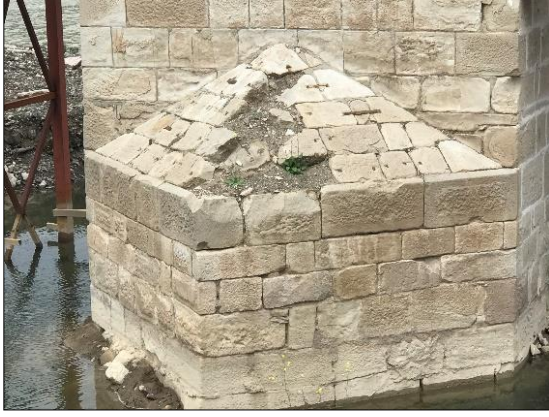
Resim 4.62. Selyaranlardaki Niteliksiz Derz Onarımları (Kaya Kişisel Fotoğraf Arşivi, 2023)
