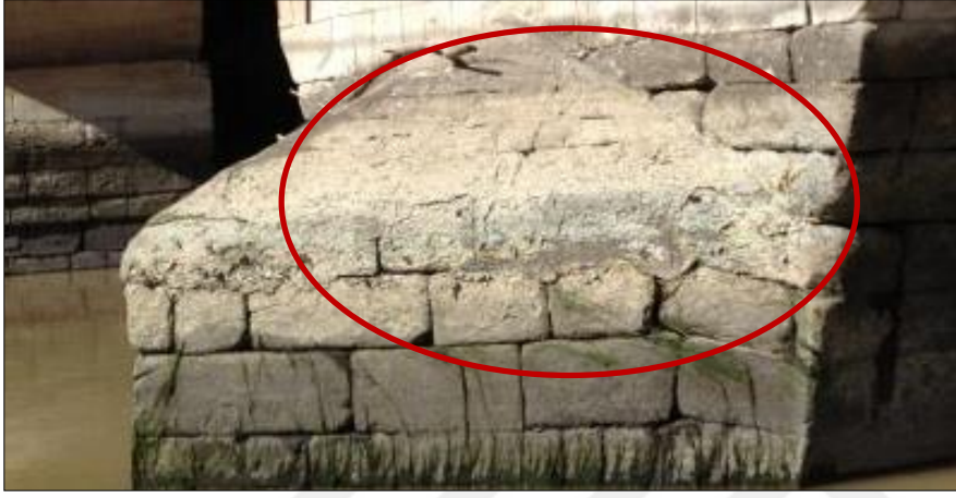
Resim 4.56. Köprü Ayaklarında Yer Alan Taşları Bağlayan Derz Harçlarında Dökülmeler (KGM Arşivi, Dilaver, 2012:13)
