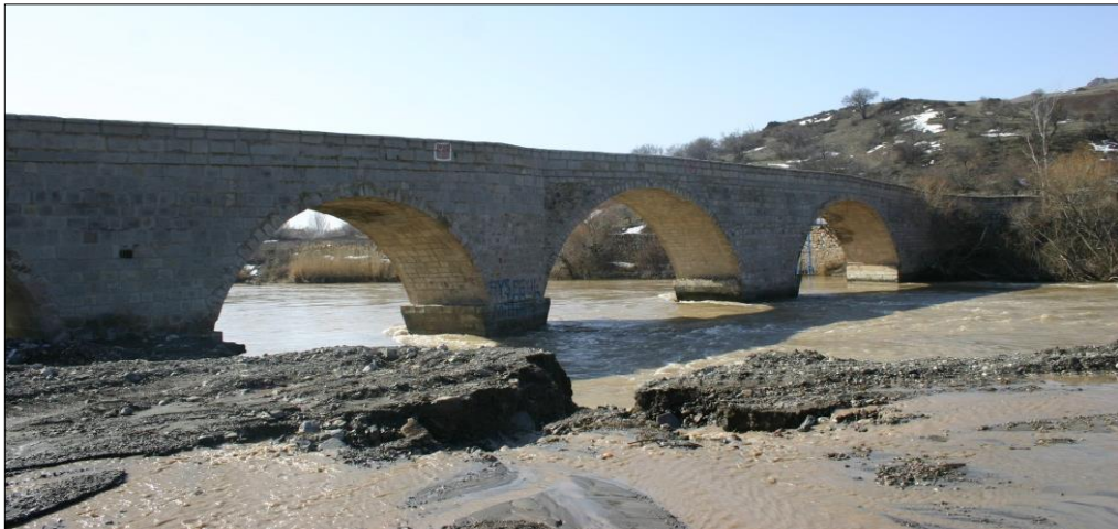
Resim 4.46. Develioğlu Köprüsünün Suların Baraj İşletmeleri Tarafından Kesilmesiyle Ortaya Çıkan Zemin Durumunu Gösteren Foto (KGM Arşivi, Dilaver, 2012:10)
