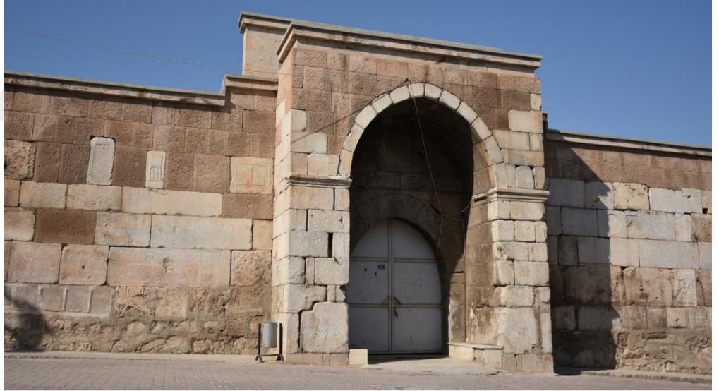
Şekil 3.41: Doğu cephesi yüzey aşınmaları genel görünüm (Bayram, 2019)
