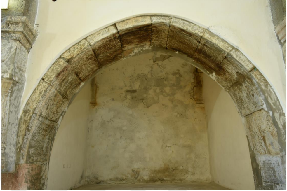
Şekil 3.35: İç mekan orta-yan sahin arası sivri kemer taş malzemedede yüzey aşınması (Bayram, 2019)
