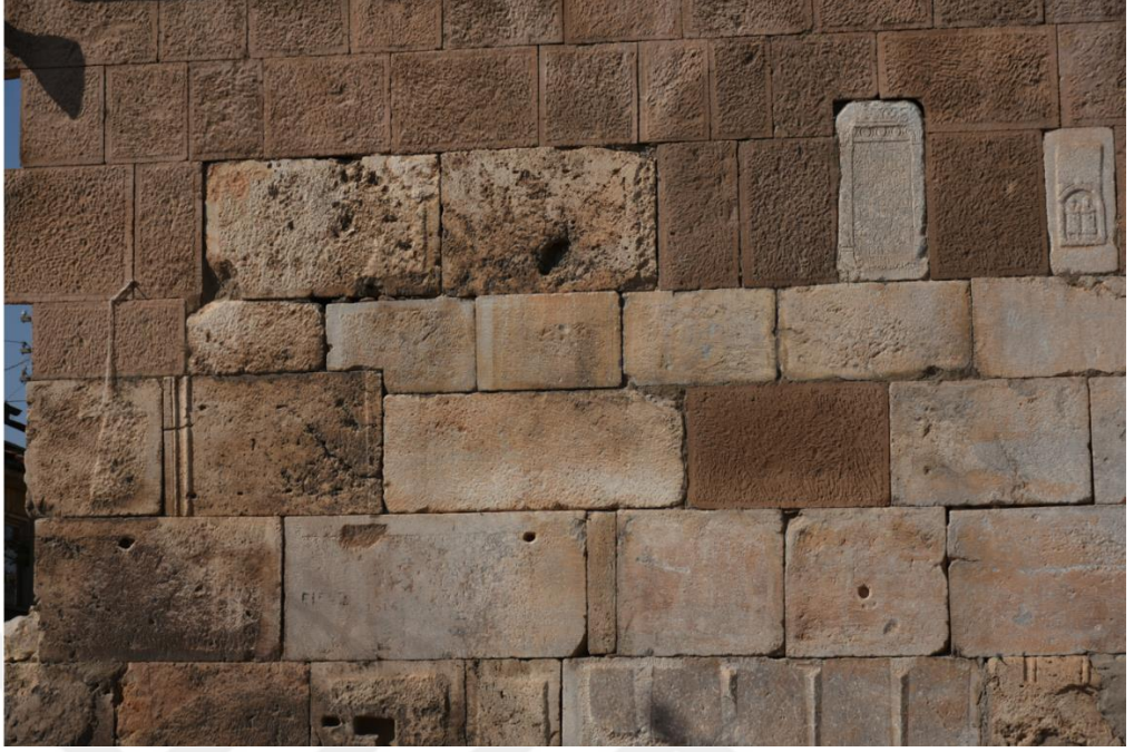
Şekil 3.42: Doğu cephesi, yüzey aşınması, parça kaybı (Bayram, 2019)
