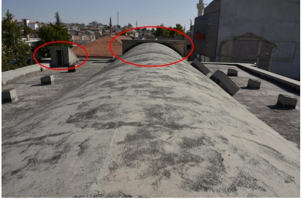
Şekil 4.25: Kadın Hanı çatı muhdes kalkan duvar ve merdiven üstü kapalı mekan (Bayram, 2019)
