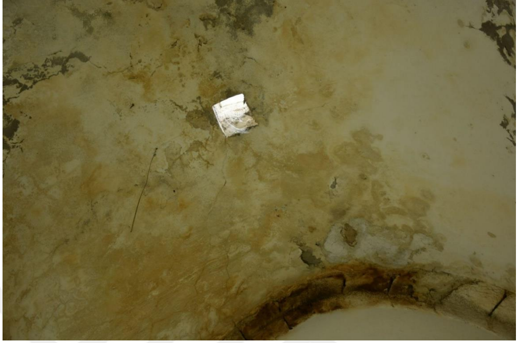
Şekil 3.37: İç mekan yan sahnın bağımsız bölüm tavanı yüzey bozulması (Bayram, 2019)
