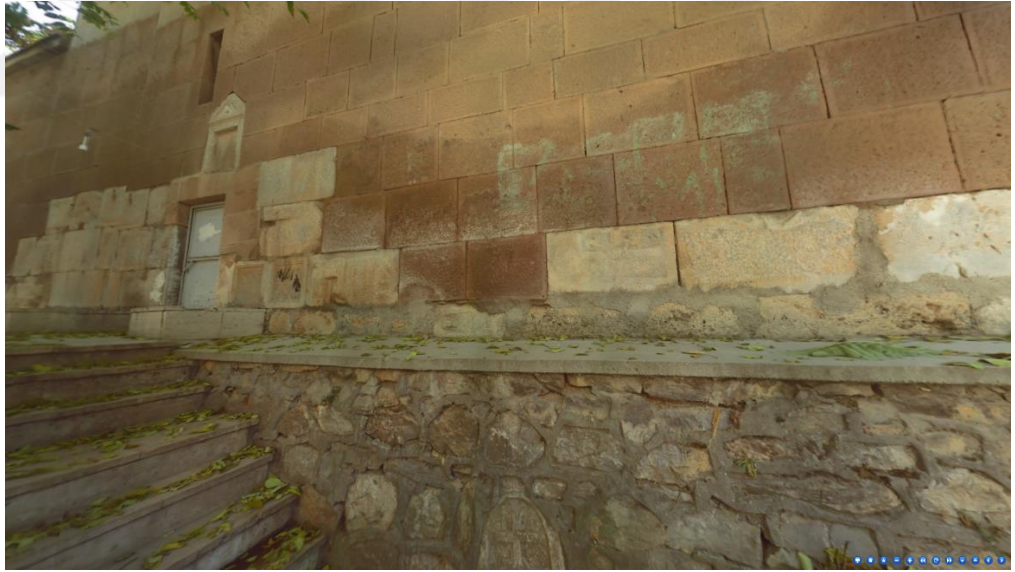
Şekil 3.47: Batı cephesi yüzey bozulmaları, muhdes ekler (Bayram, 2019)
