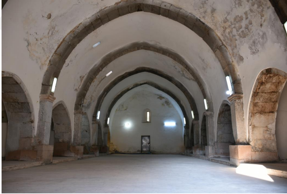
Şekil 3.28: İç mekan genel görünüm sıva-boya bozulmaları (Bayram, 2019)
