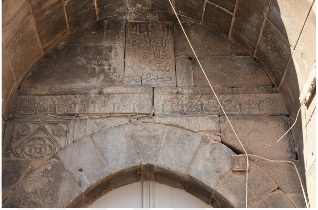
Şekil 3.46: Portal yüzey kararması (Bayram, 2019)
