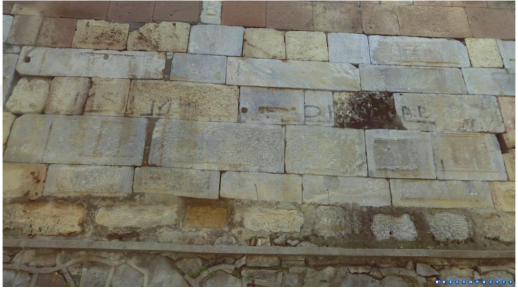
Şekil 3.49: Kuzey cephesi yüzey bozulmaları (Bayram, 2019)
