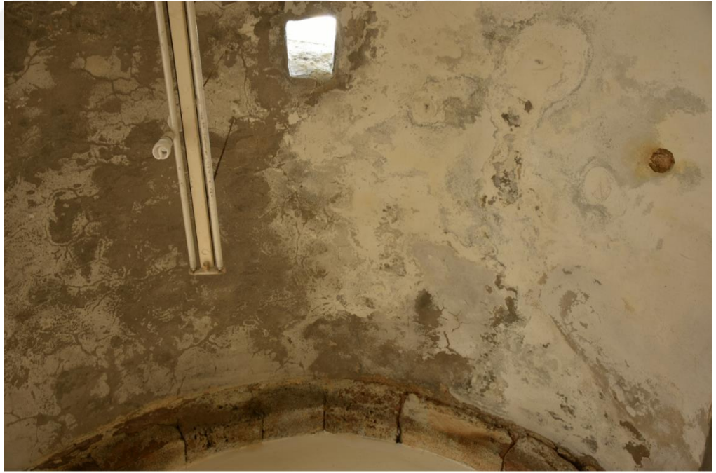
Şekil 3.38: İç mekan yan sahnın bağımsız bölüm tavanı yüzey bozulması (Bayram, 2019)
