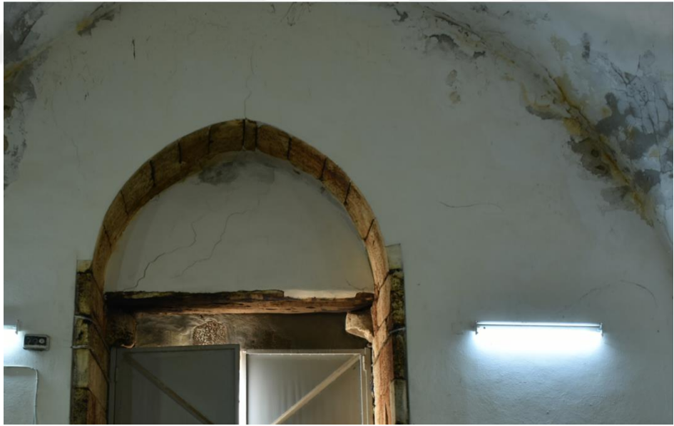
Şekil 3.31: Giriş kapısı üstü kılcal çatlaklar (Bayram, 2019)
