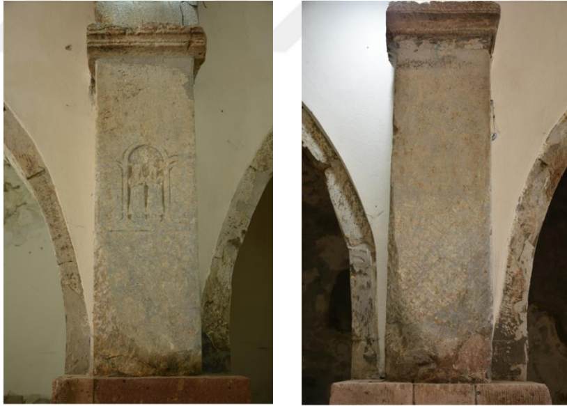
Şekil 3.33/34: İç mekan orta sahında bulunan devşirme taş malzemelerin yüzey aşınması (Bayram, 2019)
