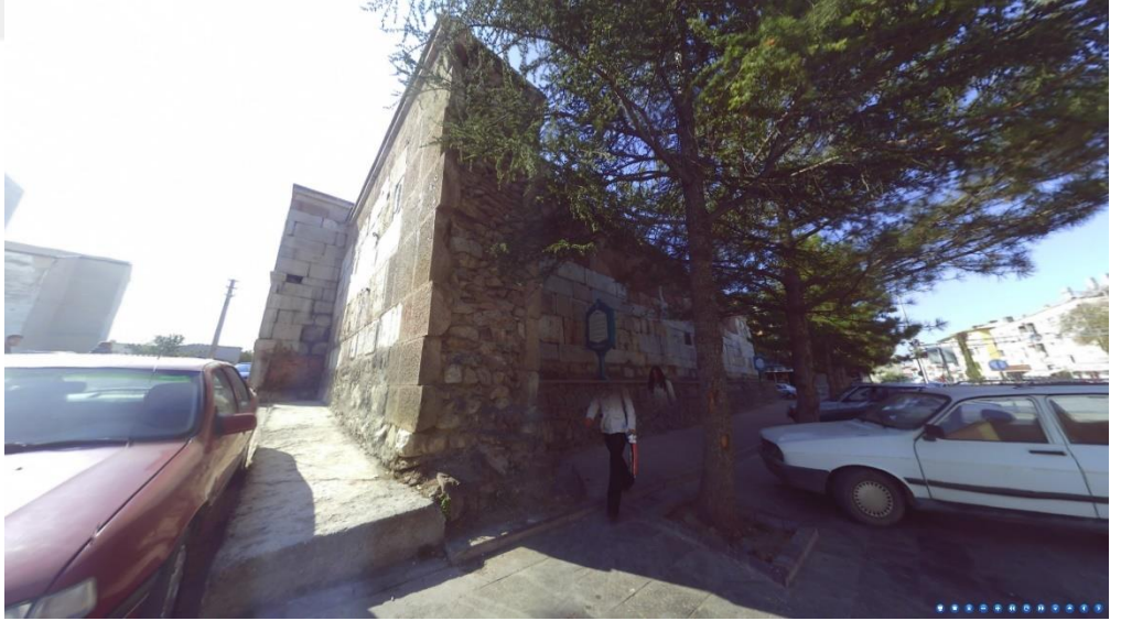
Şekil 4.32: Kadın Hanı doğu cephesi kuzey köşesi yıkılmış avlu duvarı (Bayram, 2019)
