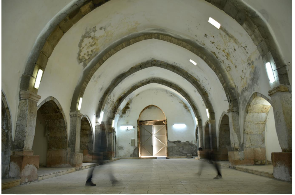
Şekil 3.27: İç mekan genel görünüm sıva-boya bozulmaları (Bayram, 2019)
