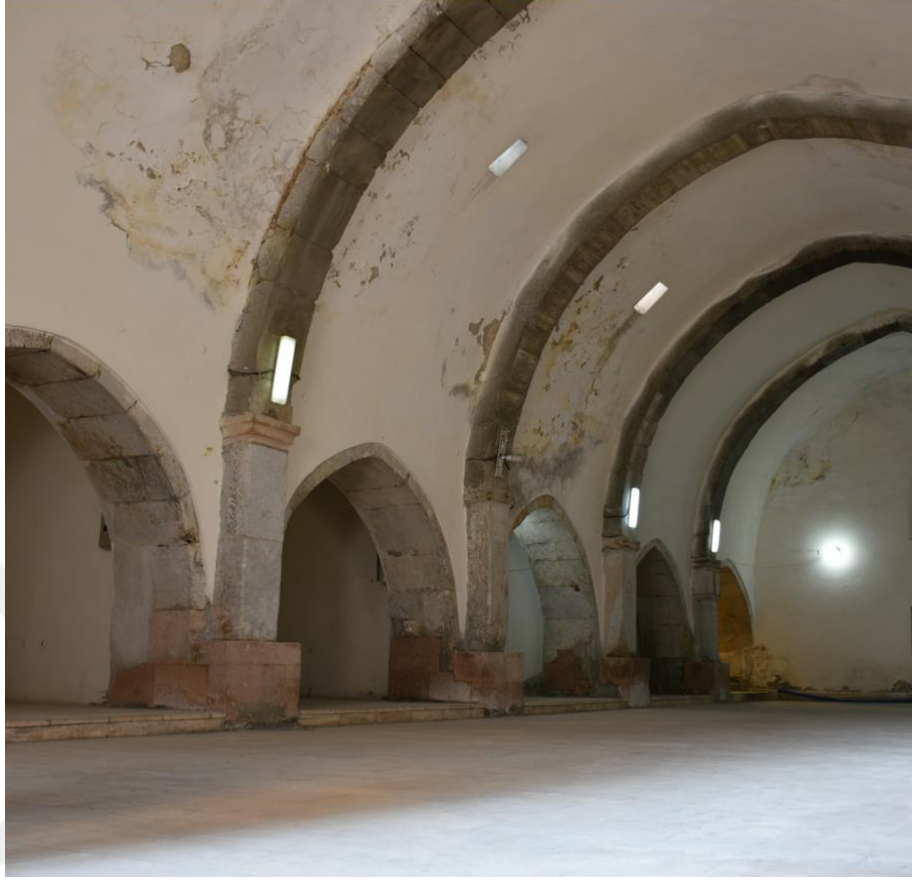
Şekil 3.29: İç mekan genel görünüm sıva-boya bozulmaları (Bayram, 2019)
