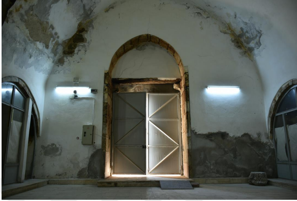
Şekil 3.30: Giriş kapısının bulunduğu iç cephe yüzey bozulmaları (Bayram, 2019)
