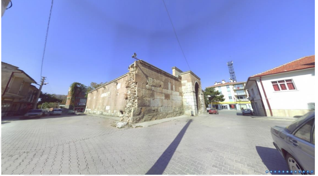
Şekil 4.31: Kadın Hanı doğu cephesi güney köşesi yıkılmış avlu duvarı (Bayram, 2019)
