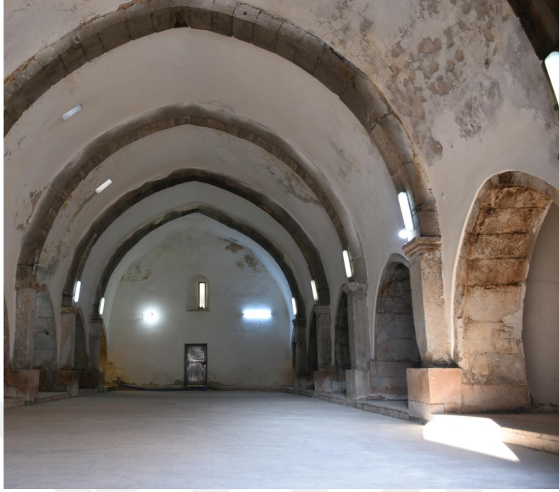
Şekil 3.32: İç mekan genel görünüm malzeme bozulmaları (Bayram, 2019)
