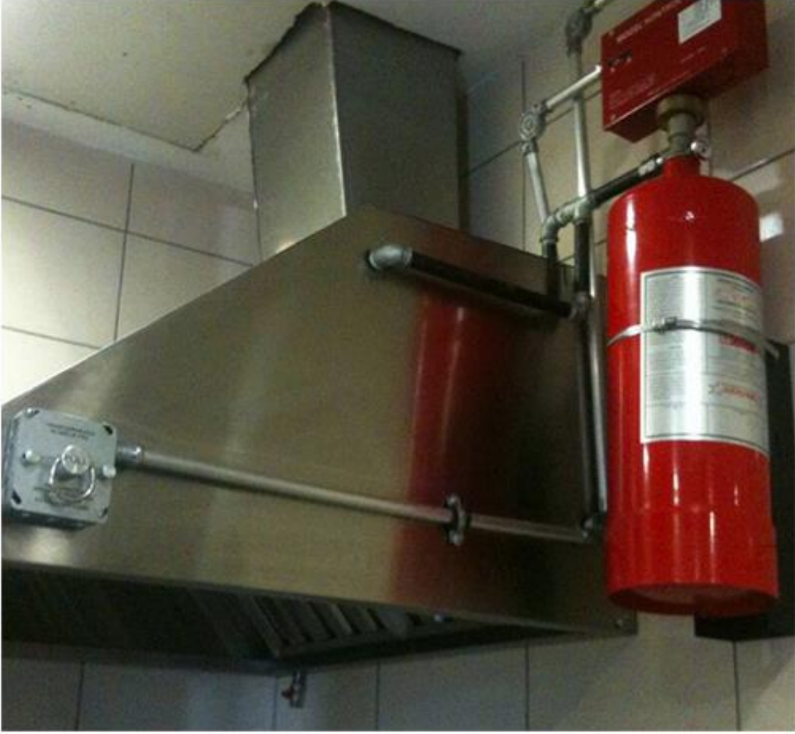
Şekil 4.13. Yangın söndürme önlemi.
