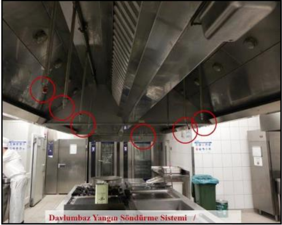
Şekil 4.14. Yangın söndürme sistemi-1.
