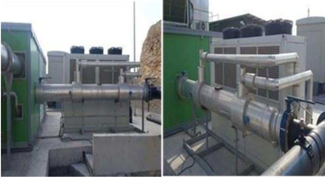
Şekil 23. Erzurum elektrik üretim tesisi chiller sistemi
