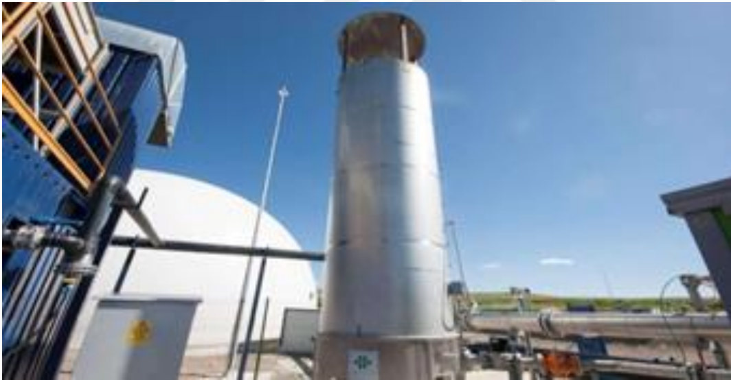
Şekil 25. Erzurum elektrik üretim tesisi flare (gaz yakmabacası)
