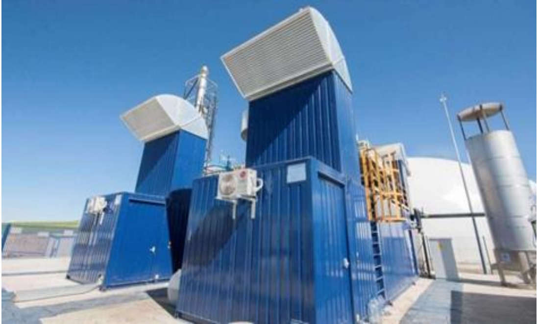
Şekil 27. Erzurum elektrik üretim tesisi gaz motorları
