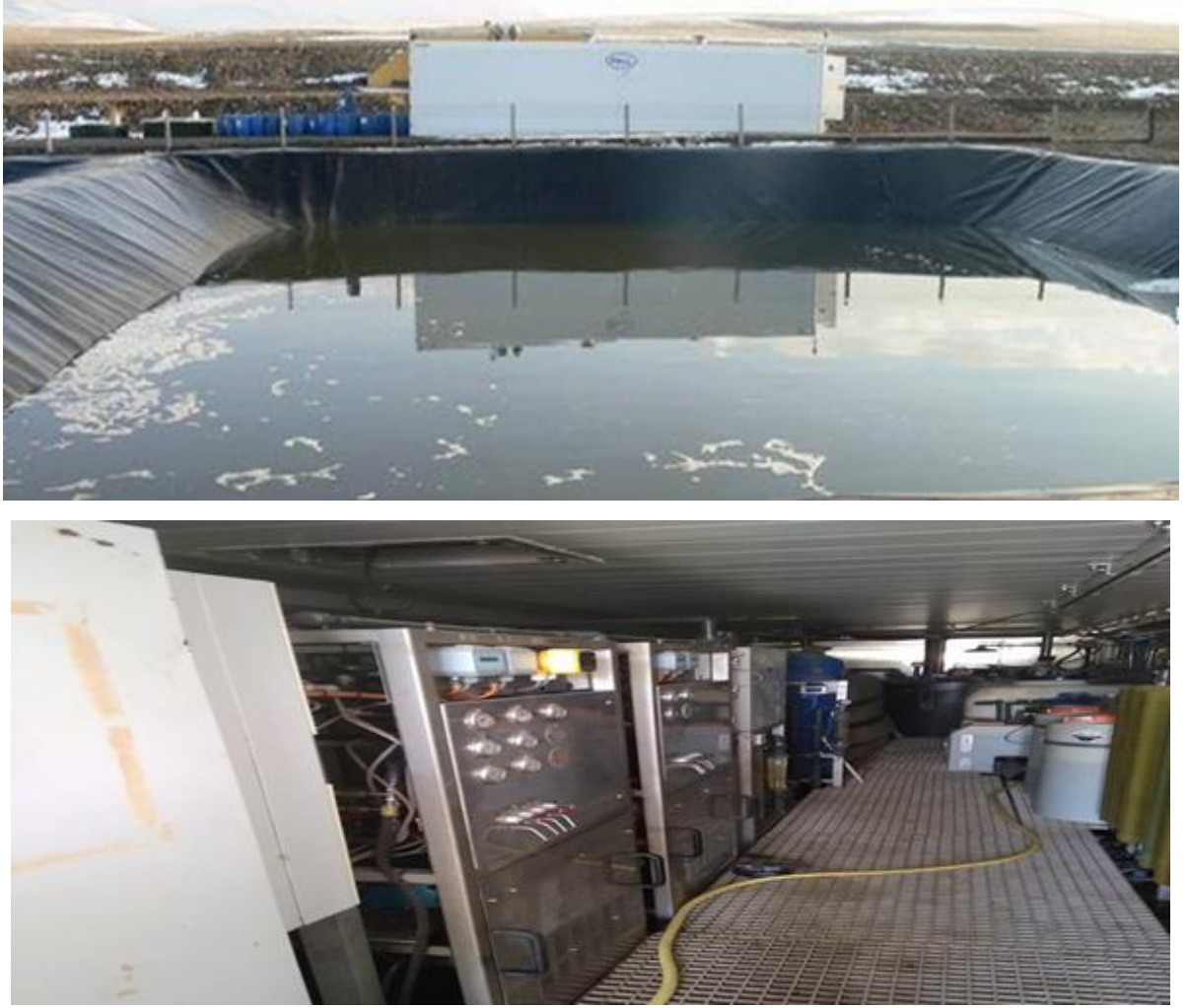
Şekil 14. Sızıntı suyu arıtma tesisi görüntüleri
