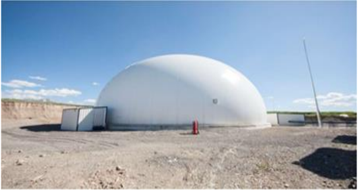
Şekil 26. Erzurum elektrik üretim tesisi gaz depolama balonu
