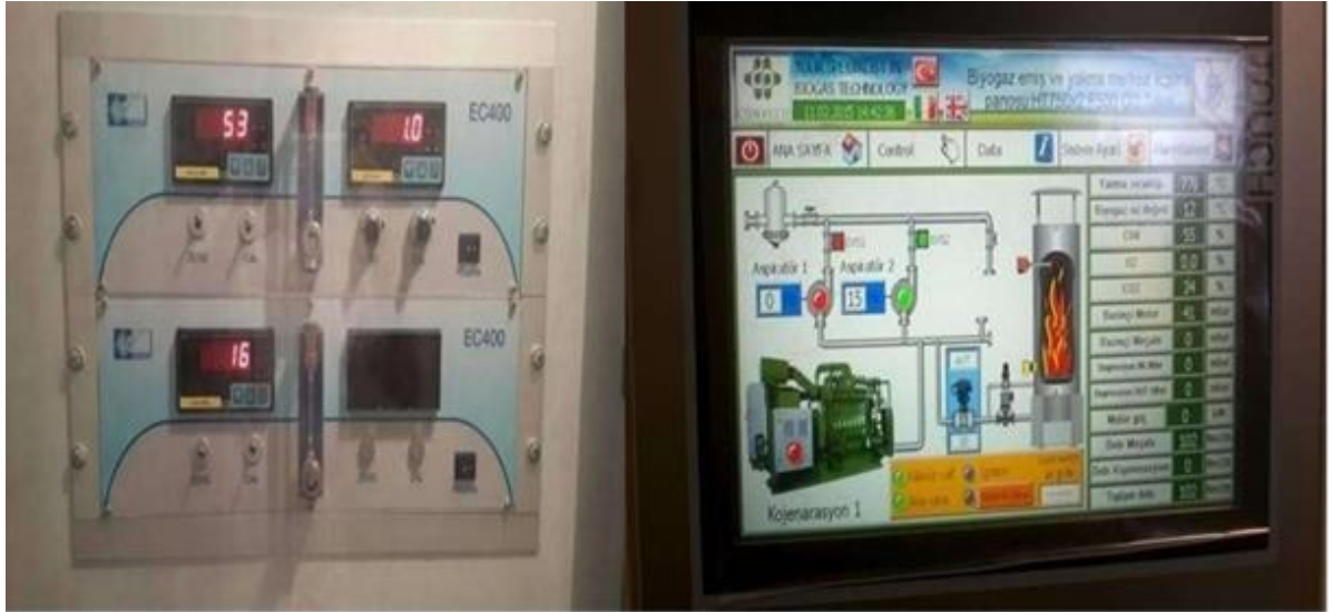
Şekil 24. Erzurum elektrik üretim tesisi booster kontrol paneli
