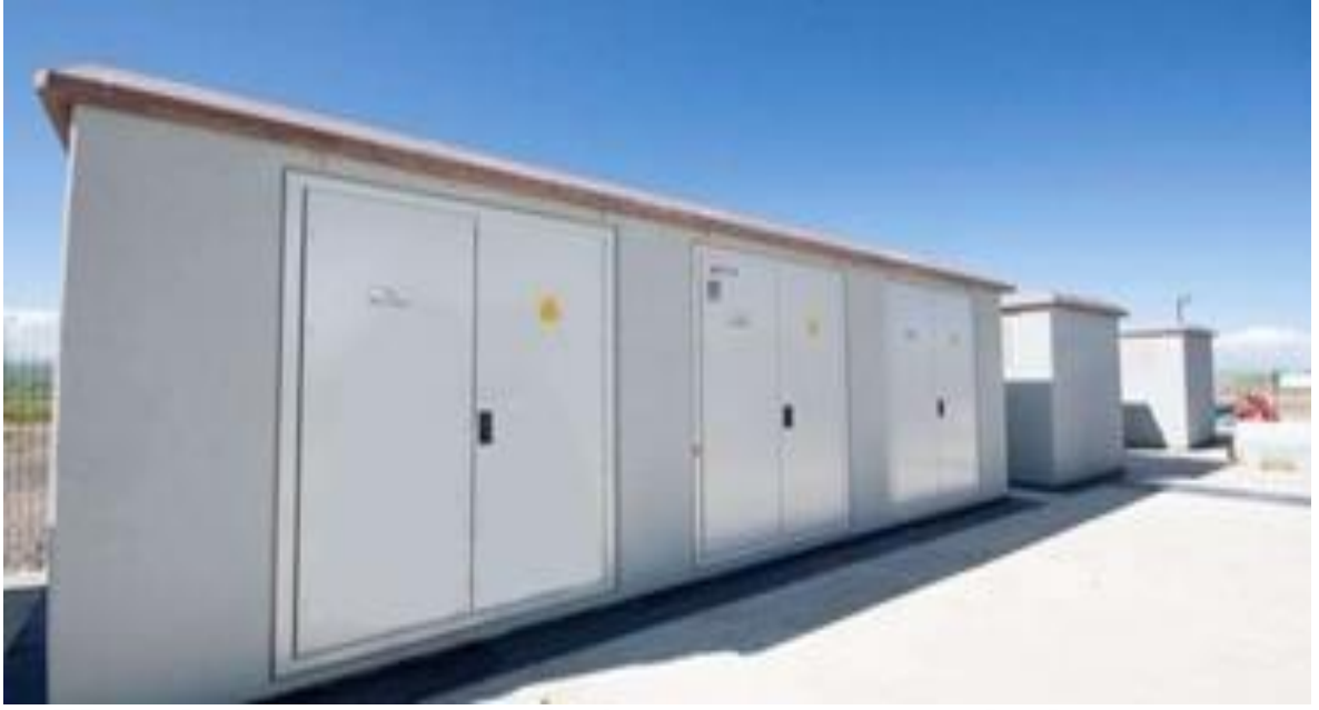
Şekil 28. Erzurum elektrik üretim tesisi orta ve alçak gerilim üniteleri
