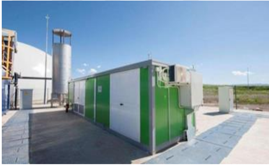
Şekil 21. Erzurum elektrik üretim tesisi Booster Ünitesi
