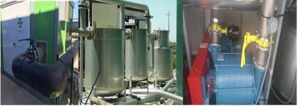
Şekil 22. Erzurum elektrik üretim tesisi Booster Ünitesi bağlantı elemanları
