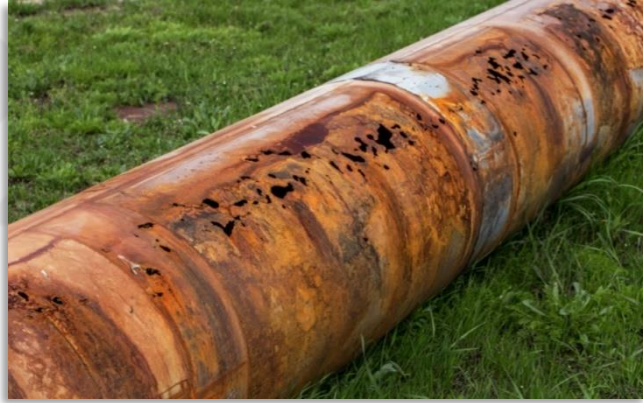
Şekil 20. Korozyona uğramış metal (URL-12).
